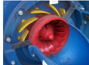
Abb. 21 Leitwerk einer Francis-Turbine für maximale Leistung eingestellt
