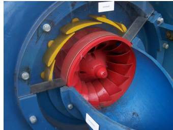
Abb. 20 Leitwerk einer Francis-Turbine für minimale Leistung eingestellt
