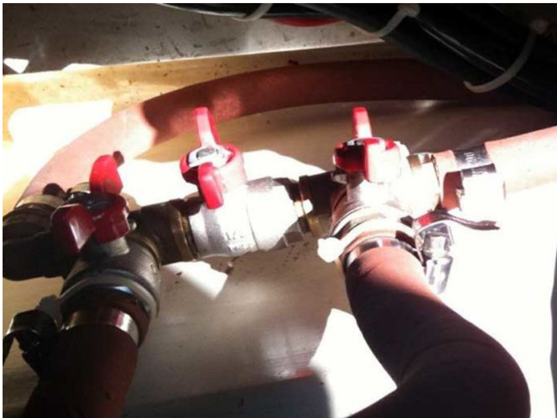
Deux robinets d'arrêt vers le moteur et un robinet by-pass
