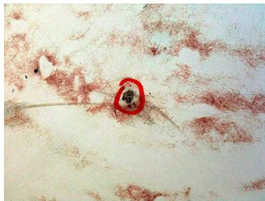
Cette osmose semble due à un excès d'accélérateur au cobalt. La photo a été prise sur l'aire de carénage de La Grande Motte
