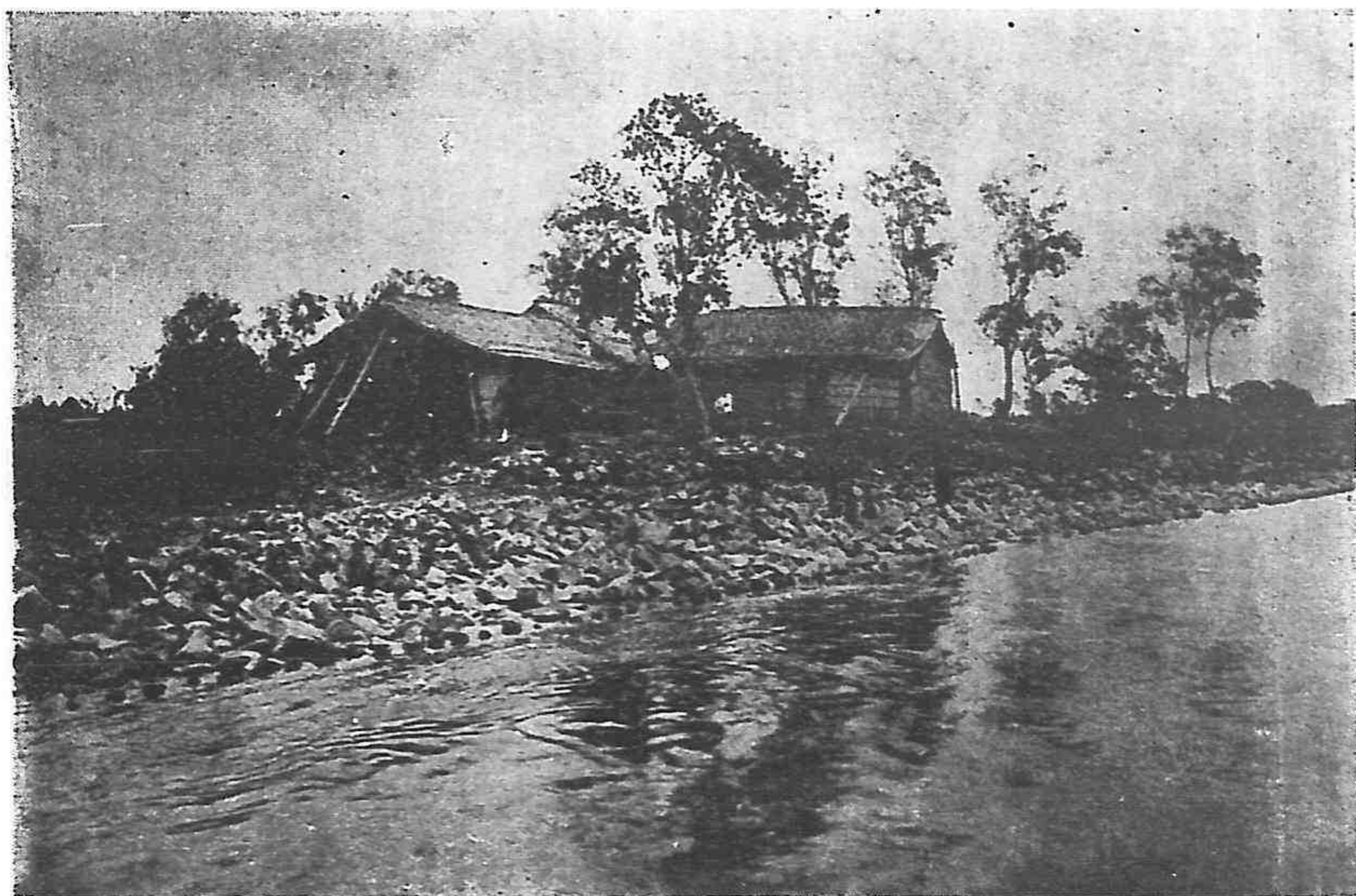
崇 明 海 塘 L 段 破 壞 情 形
