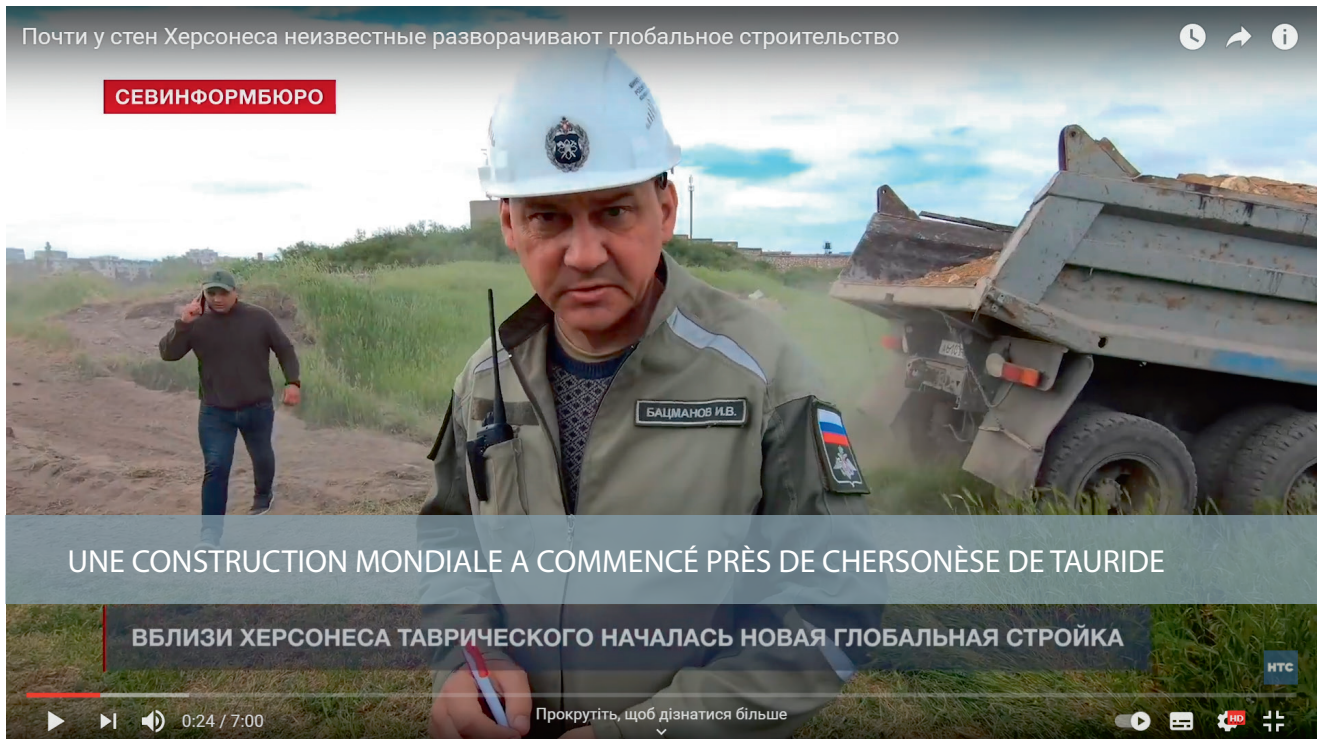
Fragment de vidéo No. 1 — Réalisation de terrassements illégaux dans la zone protégée du monument archéologique Chersonèse de Tauride avec la participation d'équipements lourds
