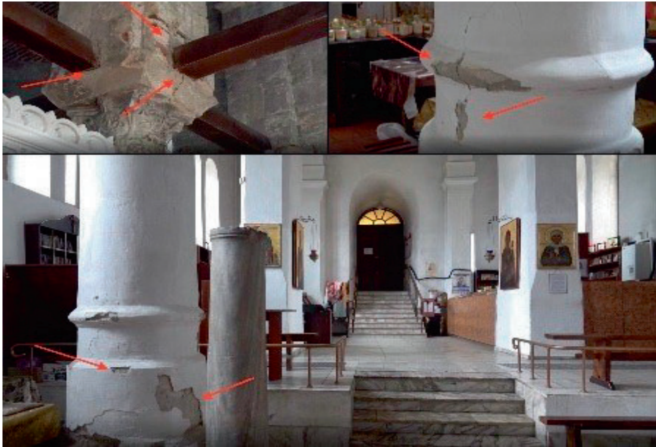
Fragment de vidéo — les fissures dans les colonnes de l'église Saint-Jean-Baptiste, qui, selon les habitants, sont apparues récemment, après la construction d'un hôtel à proximité du monument. Source - fichier vidéo du réseau social russe « Vkontakte »
