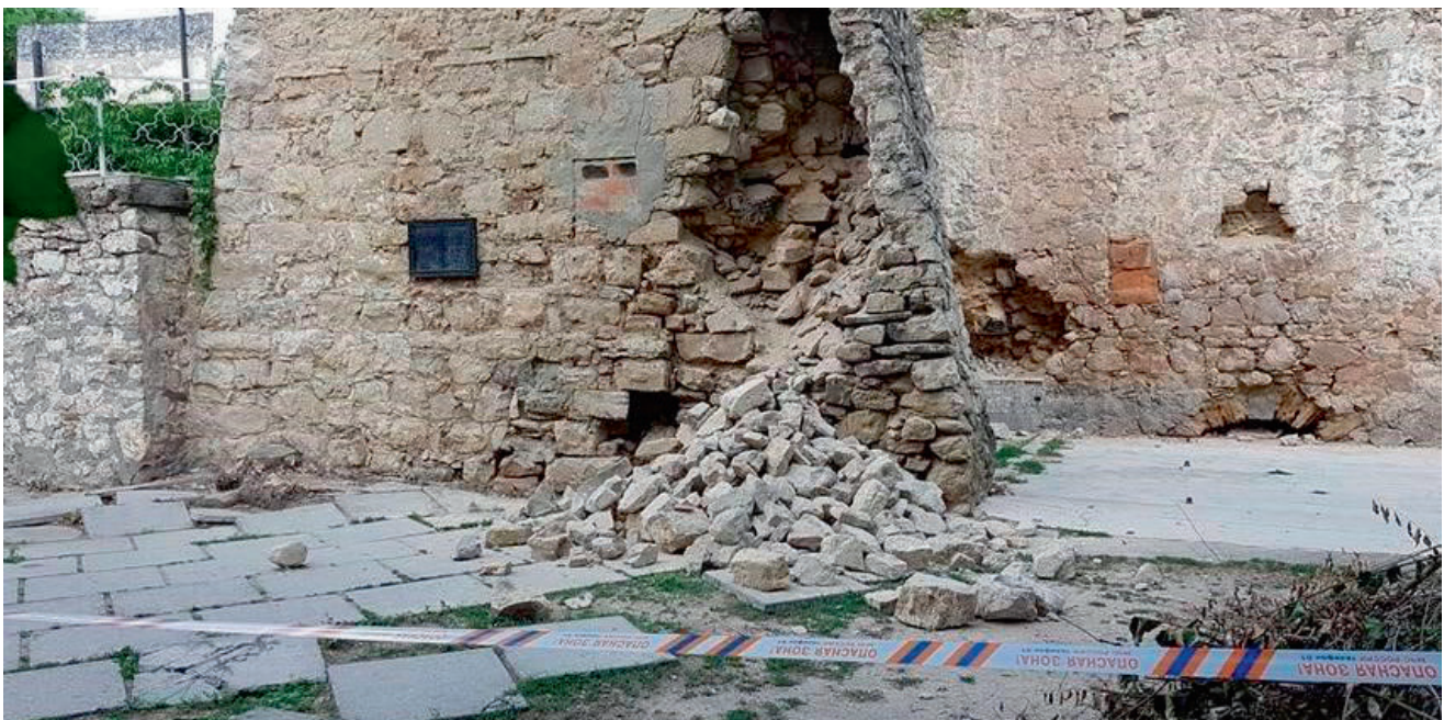
Photo du réseau social russe « Vkontakte ». La photo montre un élément du mur de la tour de Saint-Constantin avec des signes de destruction.
