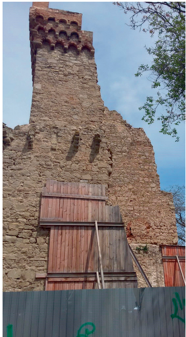
Photo du réseau social russe « Vkontakte ». La photo montre le mur de la tour de Saint-Constantin, qui est soutenu par un bouclier en bois, comme moyen d'arrêter la destruction du monument architectural.
