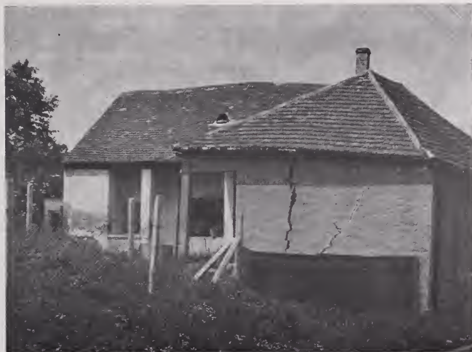
2. ábra. Mozcásokból eredő épületkár Rácalmásban
