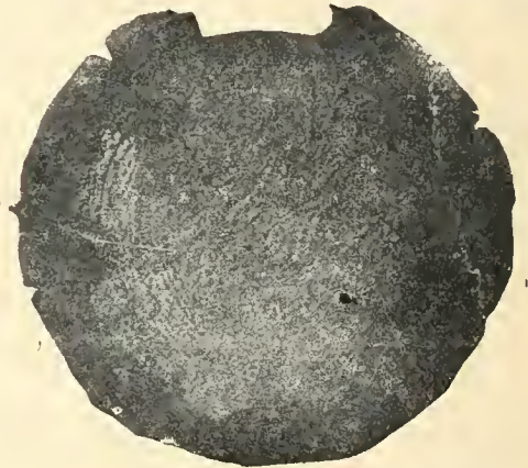
Fig. 63. — Section d'un poteau injecté de créosote, mis en service en 1905 et scié en 1921, à la hauteur de son encastrement dans le sol.
