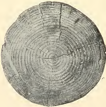
Fig. 62. — Section du même poteau après fendillement
