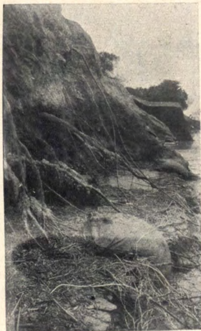
水冲堤岸塌陷 Dyke washed away
