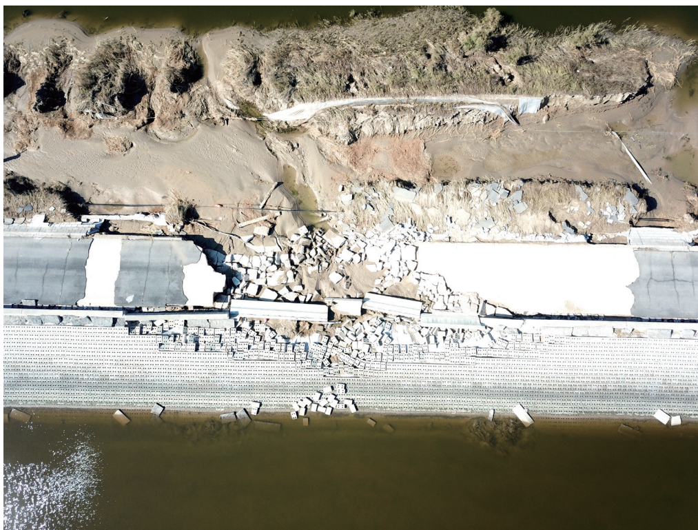
图 18 山东省东营市广饶县海堤受损
