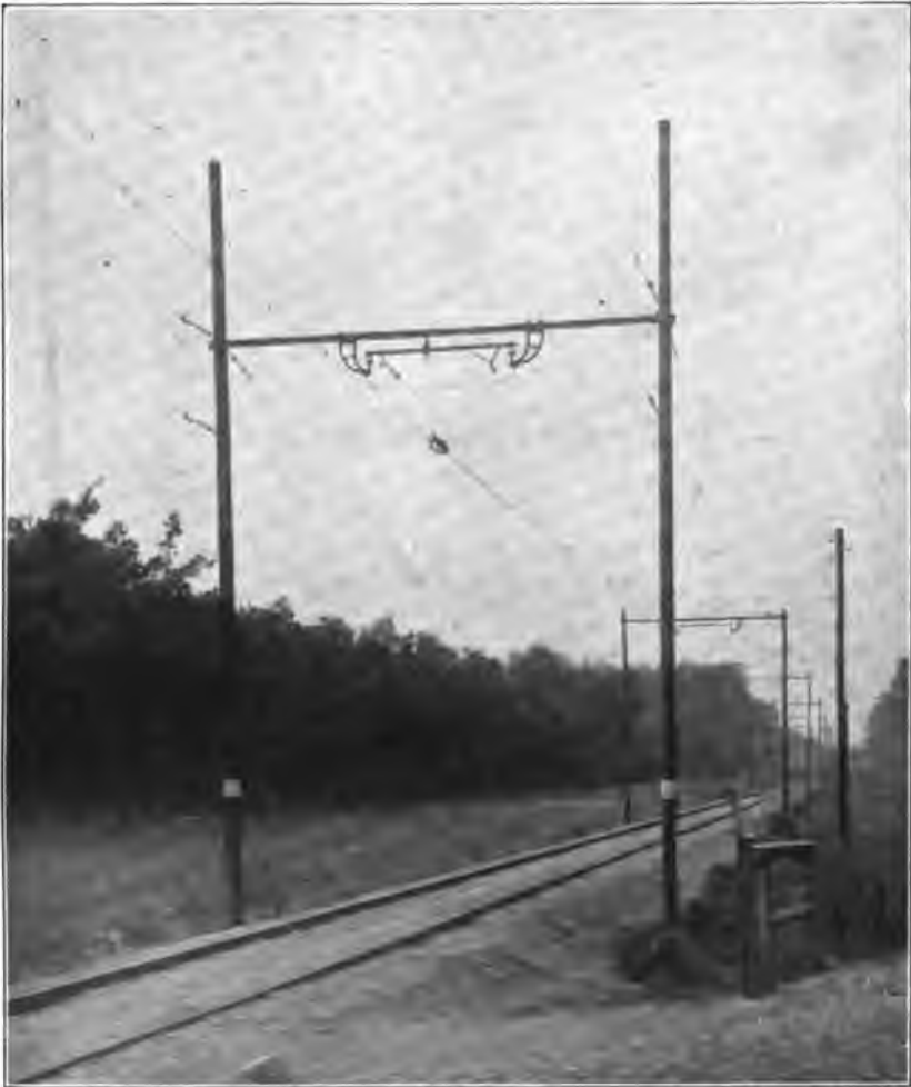
THE NIEDERSCHÖNWEIDE-SPINDLERSFELDE TRACK AND DOUBLE AERIAL SUSPENSION USED IN THE UNION ELEKTRIZITÄTS GESELLSCHAFT.
