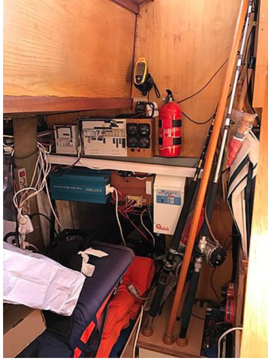
Couchette de quart tribord encombrée . Tableaux électriques, et commandes de batteries du moteur et des services.
