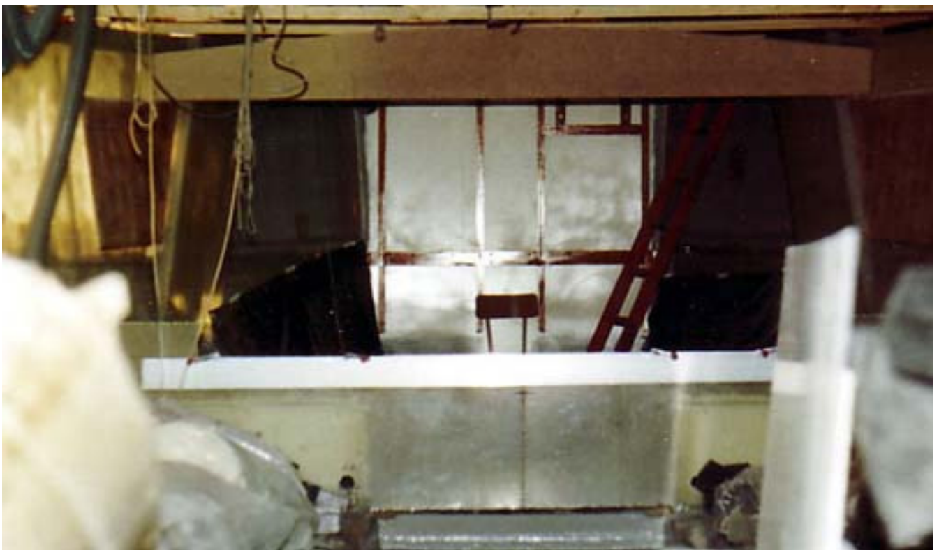
Préparation à la pose des équipets sur la cloison étanche et préparation de la stratification des ballasts, avant la pose du support d'épontille.
