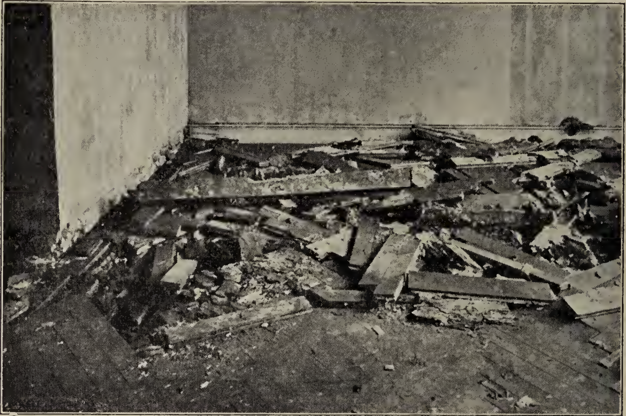
Fig. 2. Merulius auf Eichenparkett in einem Parterrezimmer. Zimmer Nr. 2, nach Aufreißen des Parkettbodens. Intacte, pilzbewachsene Eichenbretter neben den Resten des völlig zersetzten Blindbodens (Nadelholz).
