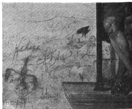
SAGGIO DI VANDALISMO.
