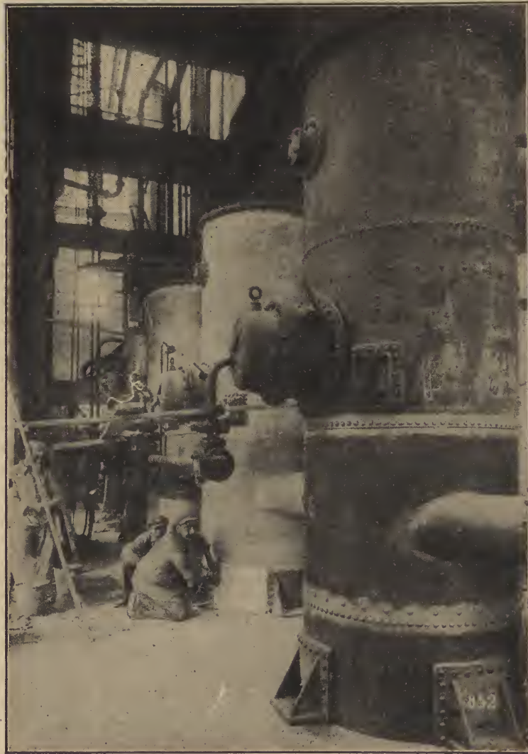
Poste de distillation de la Centrale de Comines produisant 10 tonnes d'eau distillée par heure
