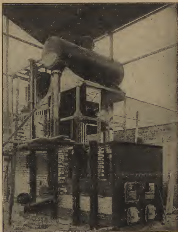
Montage d'un Générateur Duquenne avec Réchauffeur d'alimentation Pression : 25 kg — Foyer mécanique Erith. Station d'Essais de la S te G ie d'Evaporation, Procédés Prache-Bouillon.
