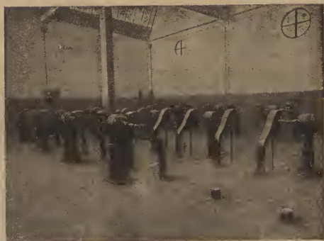
Installation d'aspiration pour meules à métaux
