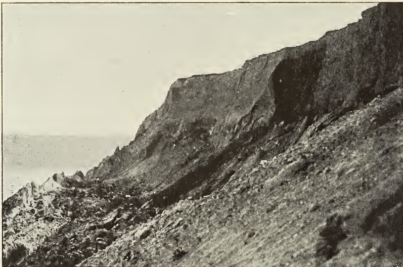
Abb. 27. Frischer Abbruch im Geschiebemergel der Küste bei Brüsterort infolge von Durchfeuchtung, welche sich durch die dunkle Färbung an der Abbruchstelle kundgibt. Aufgenommen im September 1904.
