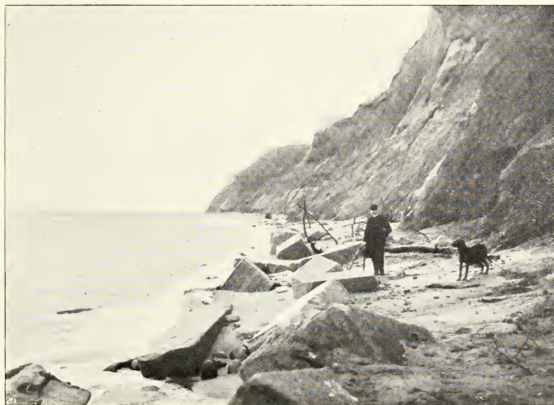
Abb. 44. Dieselbe Schutzmauer wie in Abb. 42 und 43 nach den Stürmen im Januar 1905.
