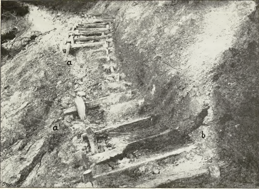
Abb. 30. Treppe in der Fuchsschlucht bei Warnicken. Der obere Teil durch die bei a ablaufenden Quellwässer zerstört, der andere Teil durch das aus der Kluft bei b herausrinnende Wasser stark beschädigt. Aufgen. im September 1904
