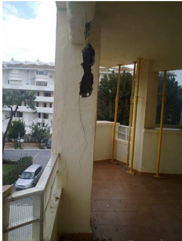
6- Detalle de fisuras del revestimiento del pilar de
