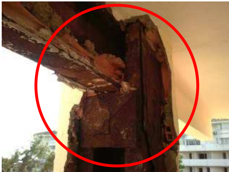
3 - Detalle de la corrosión en nudo entre pilar y viga de acero en balcón sur 2º piso
