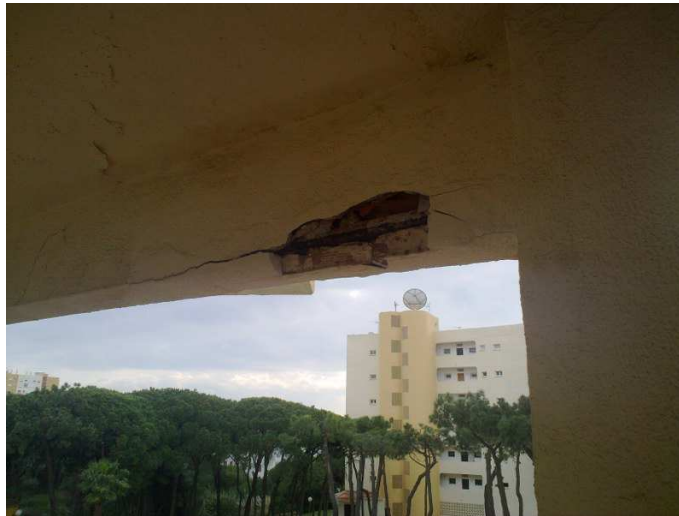
8 - Detalles de fisuras en revestimiento de vigas en fachada sur en 2º piso, previo a la realización de catas.
