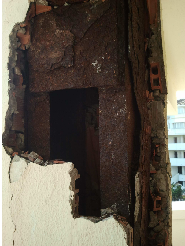
4 - Detalles de la corrosión que presenta el pilar del balcón 2º piso
