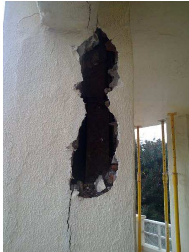
7 - Detalle de corrosión del pilar de acero en
