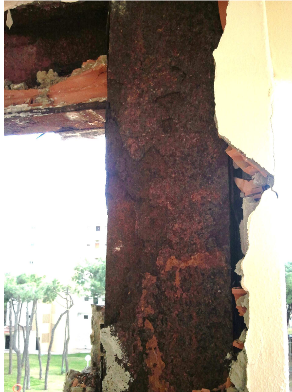
5 - Detalles de nudo estructural entre pilar y viga en balcón de 7º piso
