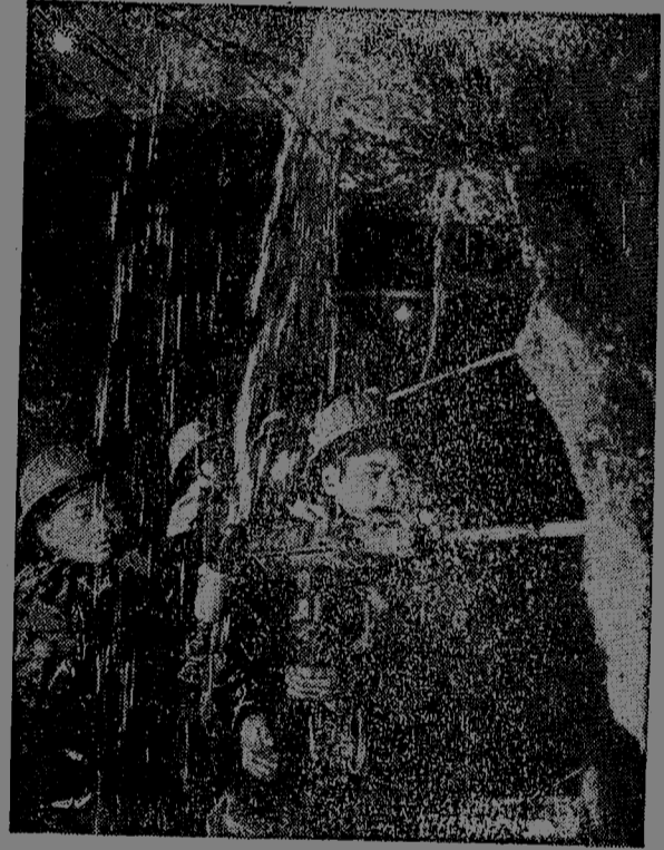
铁道兵某部战士在新的铁路线施工中，冒着地下暗河的流水，开凿隧道。
