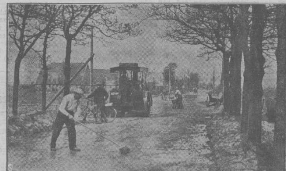
HET CIRCUIT VAN DRENTE. — Het wegdek wordt verbreed en op verschillende plaatsen vernieuwd. Het werk wordt uitgevoerd in werkverschaffing.
