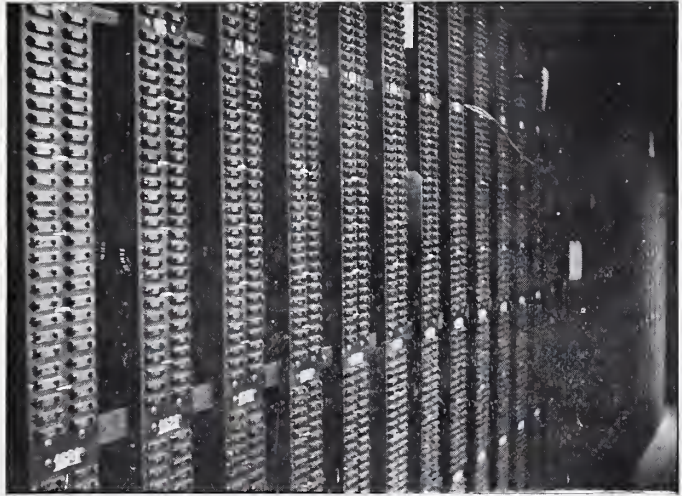
Een der omschakelrekken.
