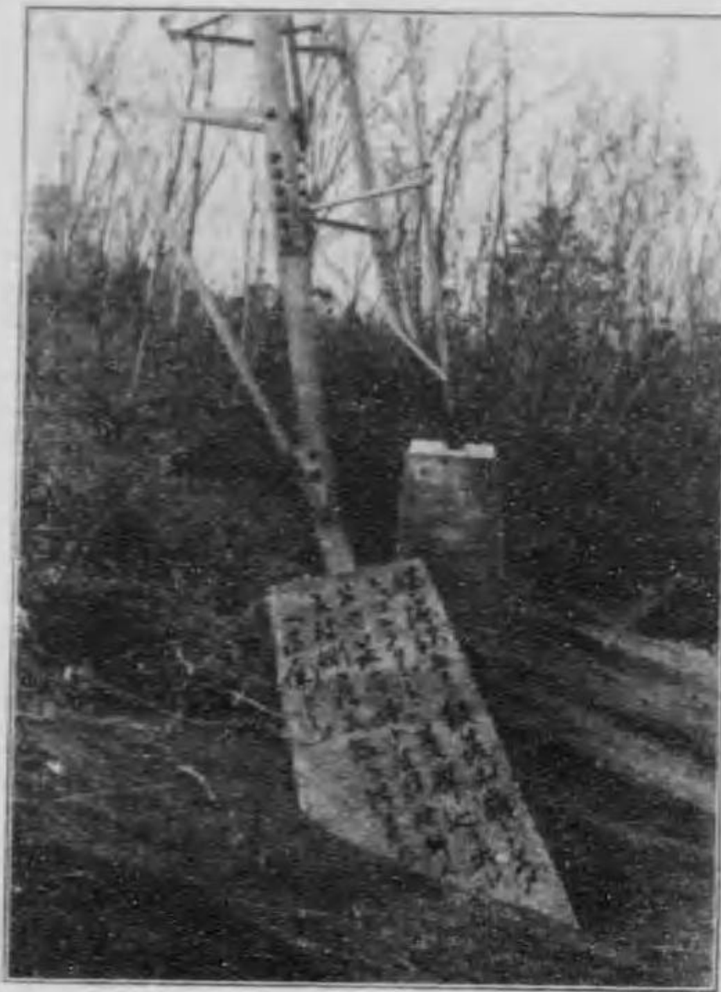
東京電燈株式会社 山崩れによる鐵塔の被害 (正面より見たるもの)
