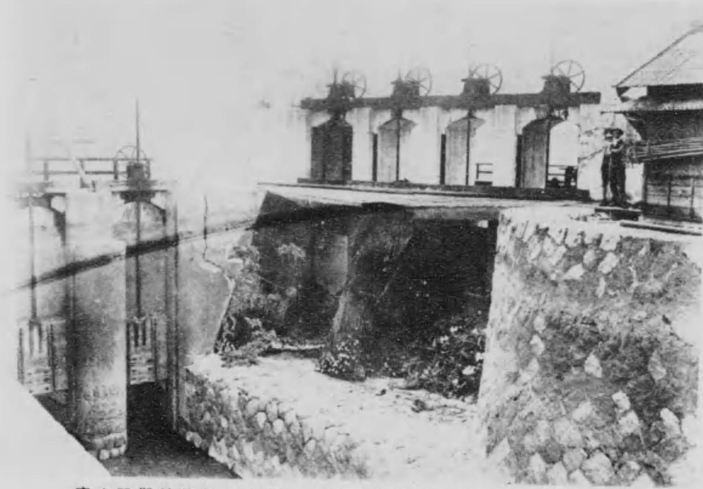
富士瓦斯紡績株式會社 内山水力制水門及び溢水吐の龜裂
