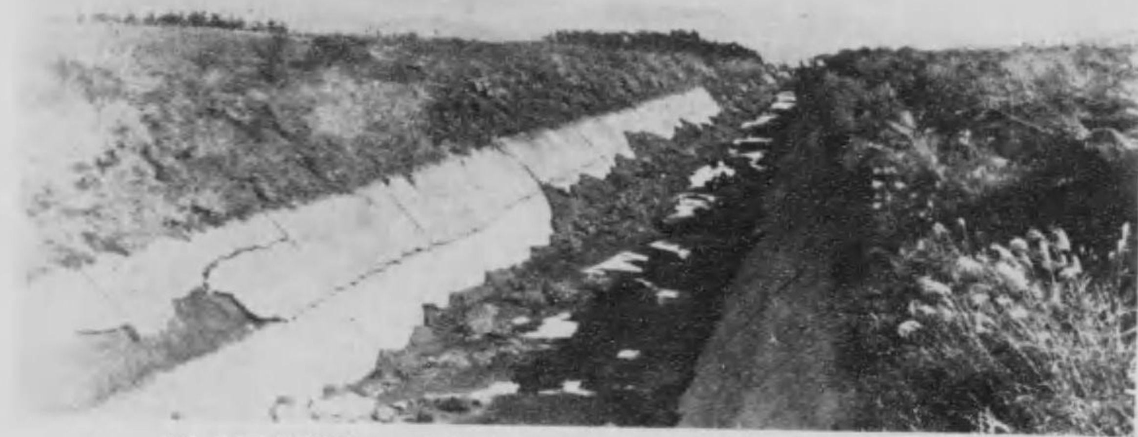
富士瓦斯紡績株式會社 須川水力下開渠法混凝土龜裂
