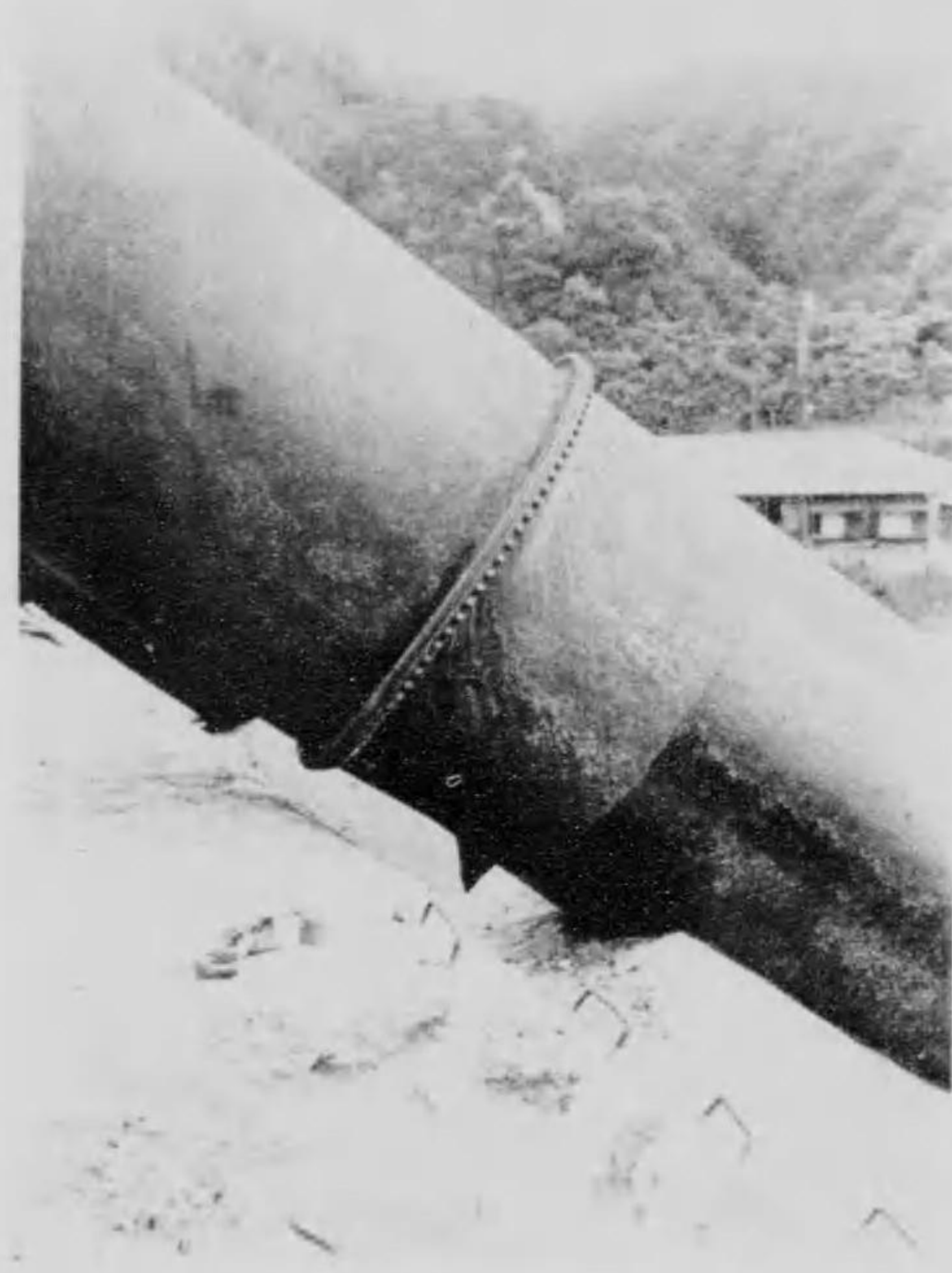
東京電燈株式會社 社用八ツ澤水壓管接手部龜裂及び受空滑塵狀況
