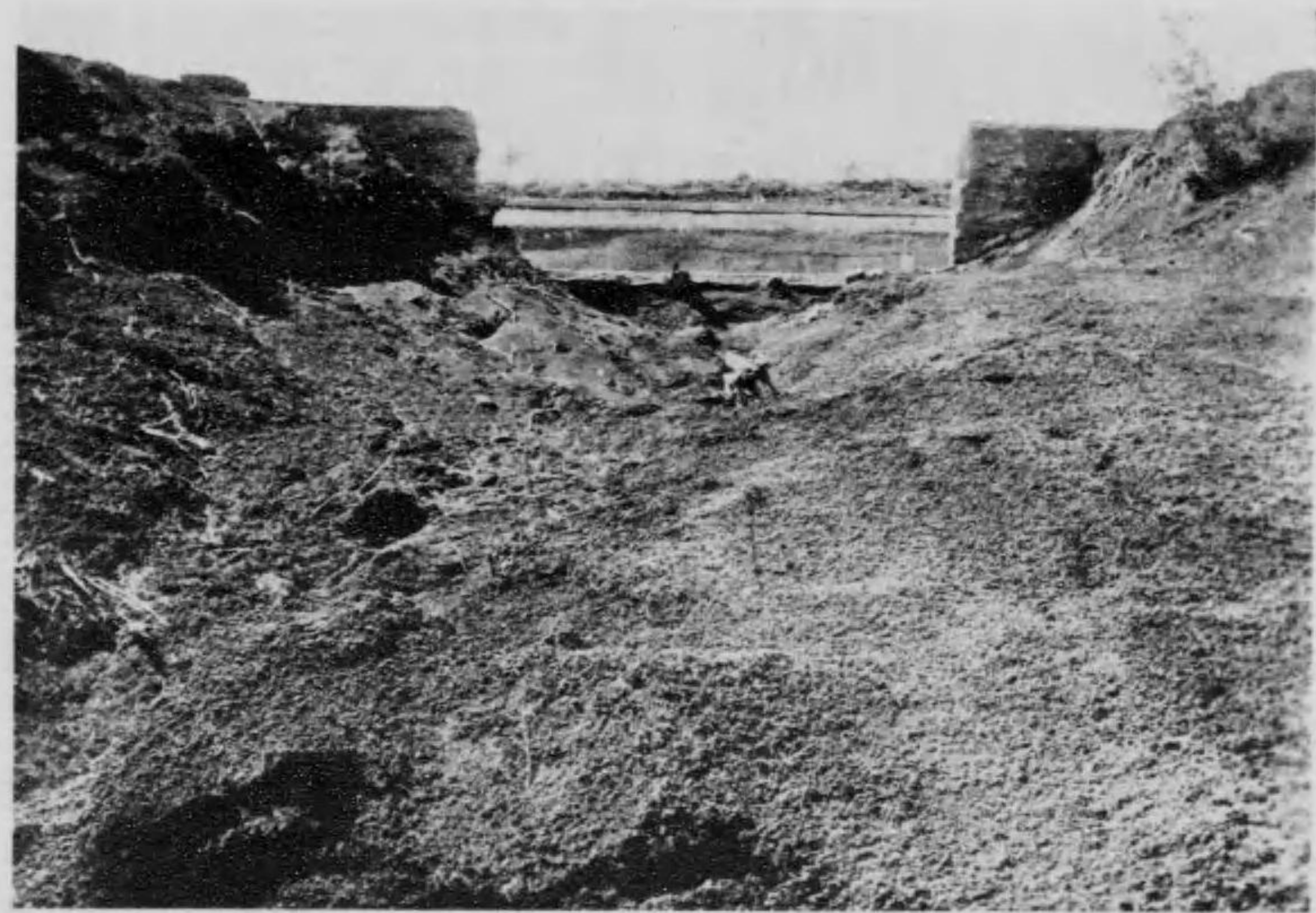
東京電燈株式會社 桂川忍野水路破壞狀況
