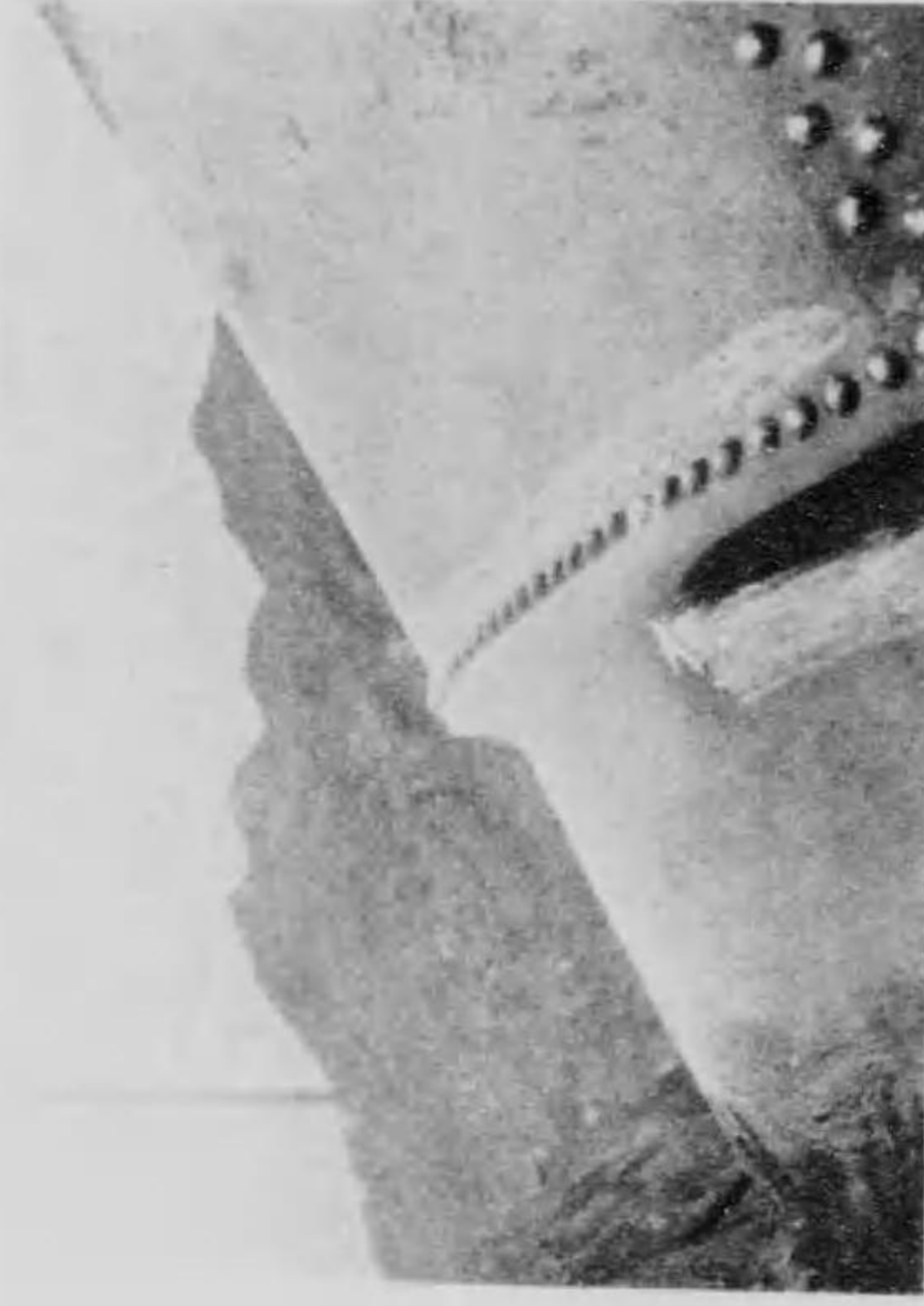
富士瓦斯紡績株式会社 内山水力水壓鐵管の一部(中央)
