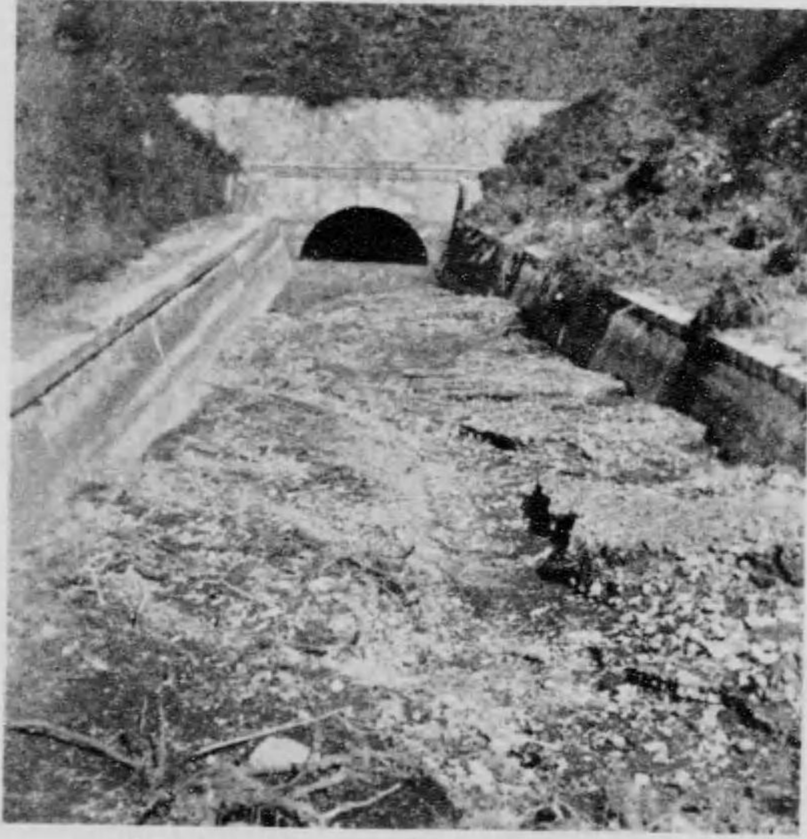
東京電燈株式会社 鹿留水力開渠へ土砂の押し込みたる状況
