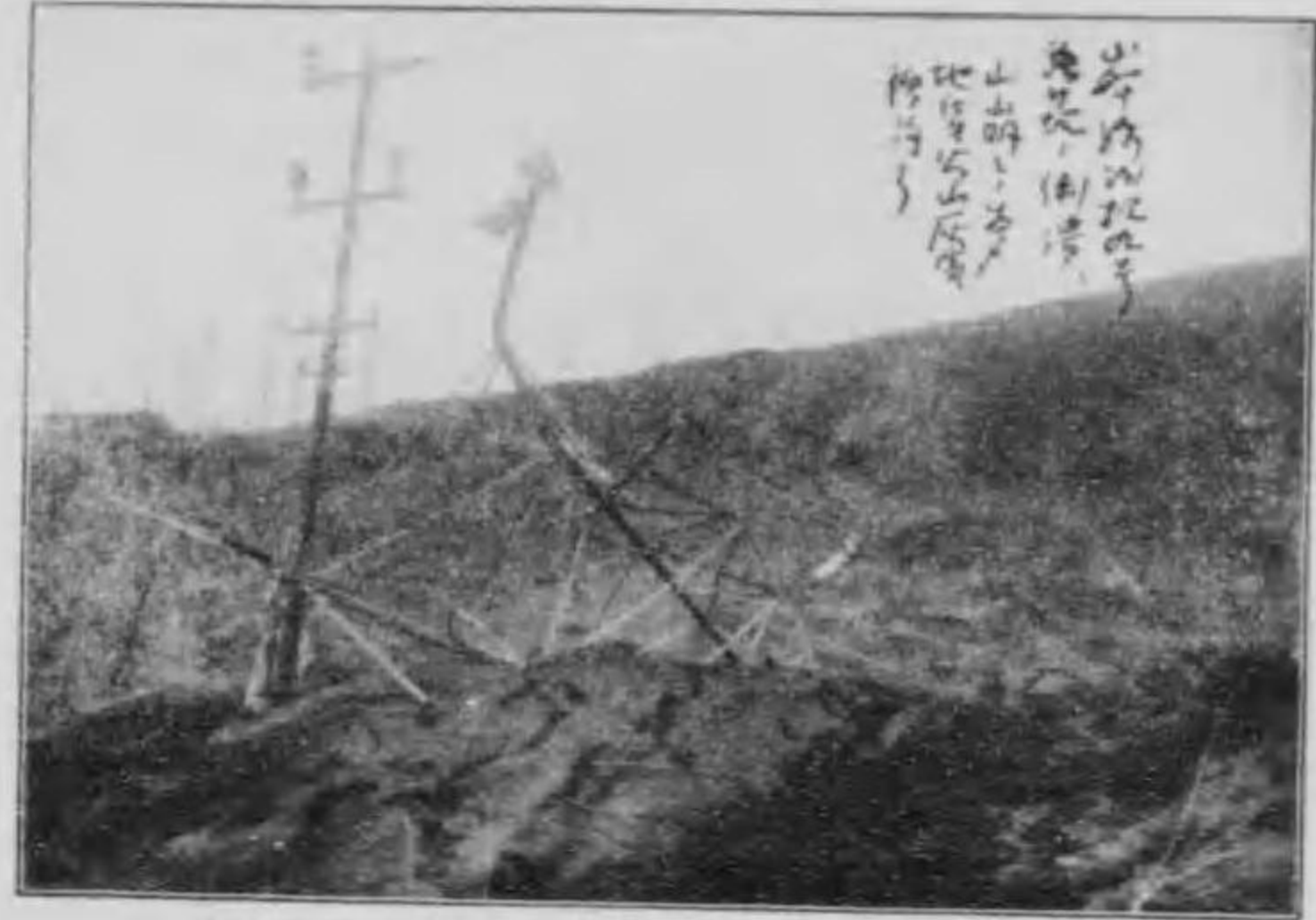
東京電燈株式会社 (峯線) 山崩れのため倒壊せる鐵塔
