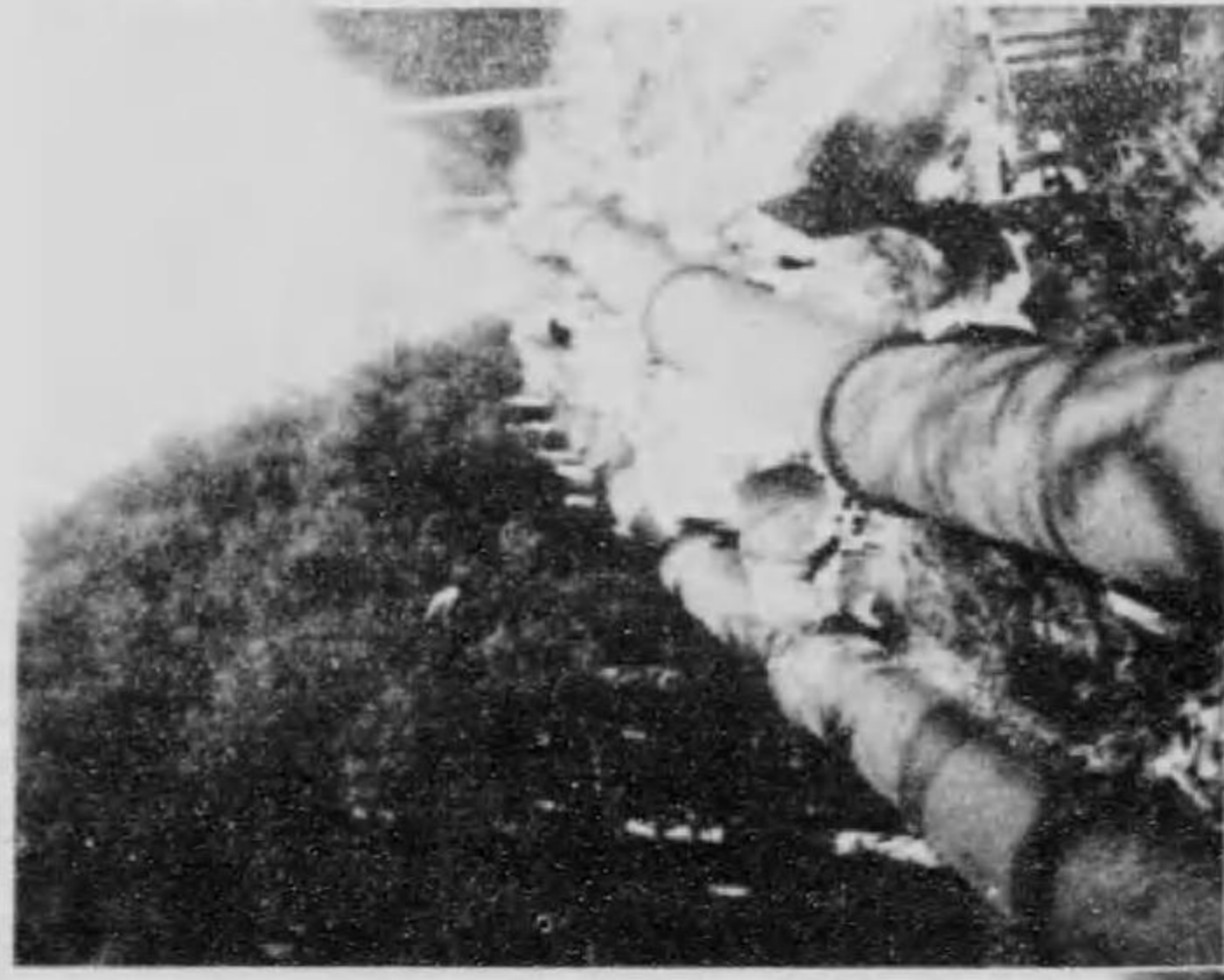
東京電燈株式會社 塔ノ澤發電所水壓管被害狀況
