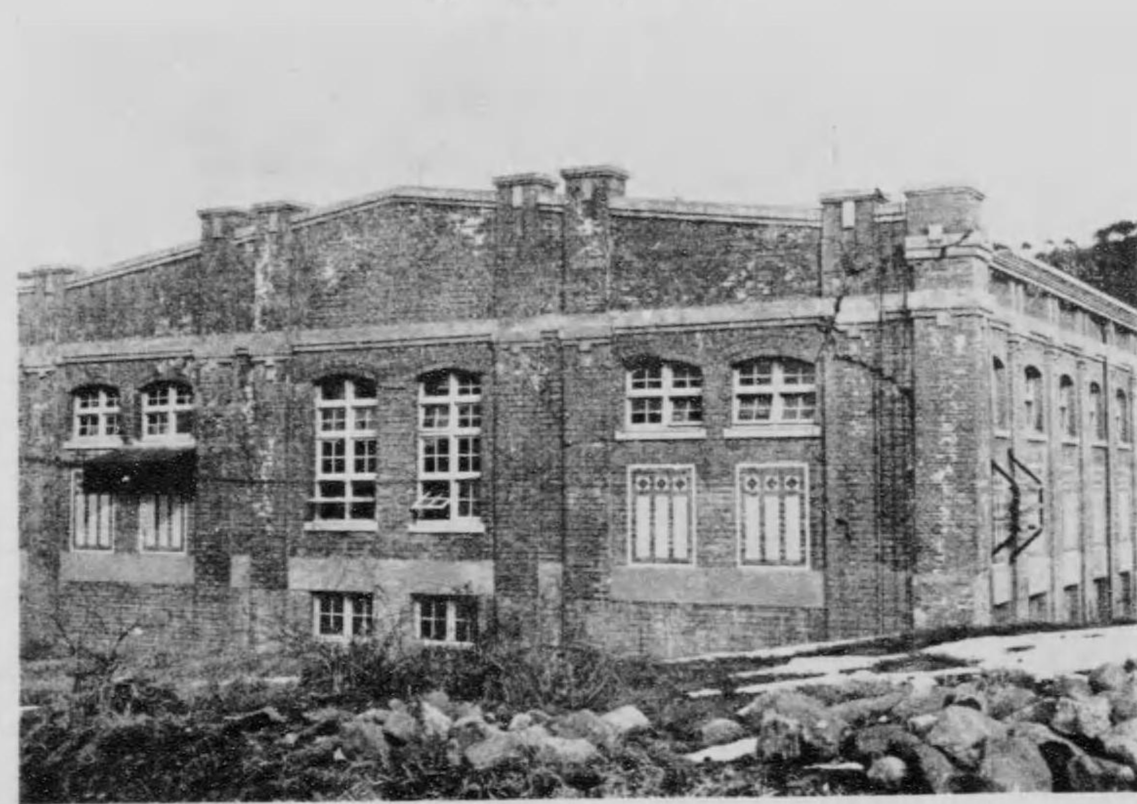
東京電燈株式會社 谷村發電所震害狀況
