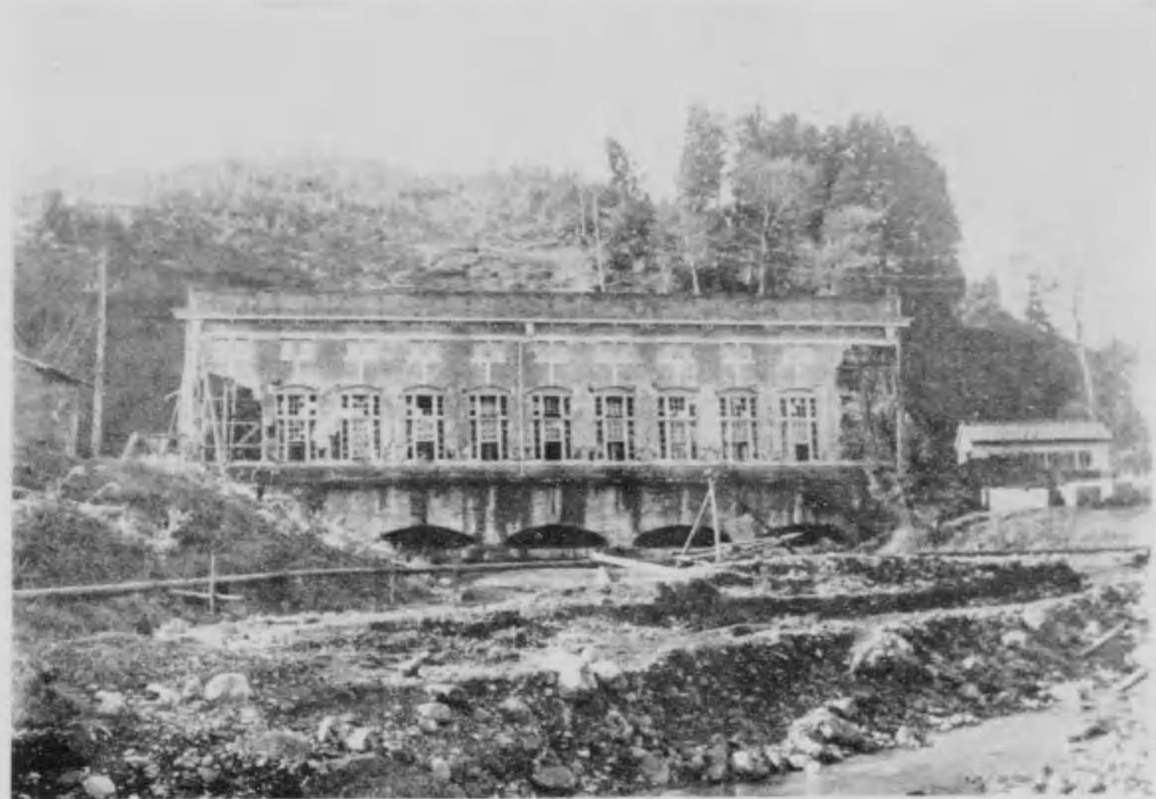
富士瓦斯紡績株式會社 須川發電所龜裂及放水路崩壞
