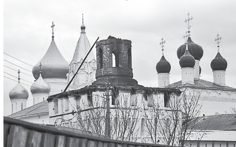
Так выглядит южная башня стены Никитского монастыря после пожара
