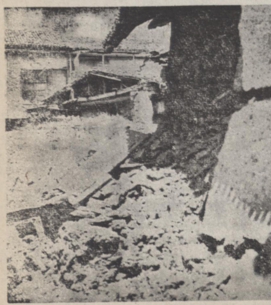
در عکس بالا شکافی که از زلزله بر دیوار وارد آمده و قسمتی از بنا در هم ریخته است دیده میشود
