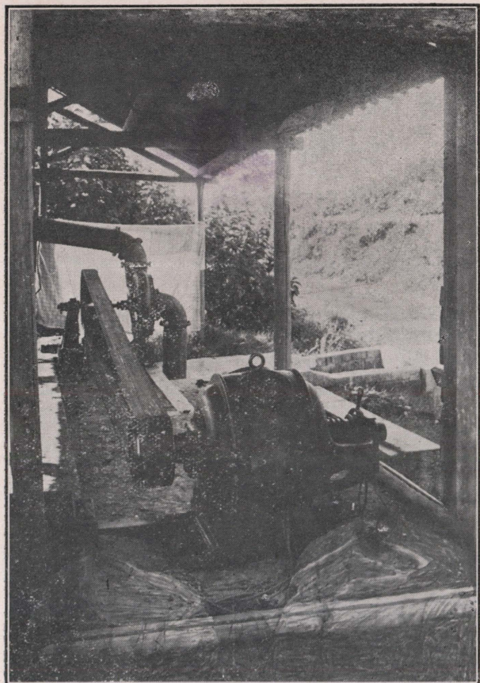
武錫區辦事處犀水站內部機件裝置情形之一
