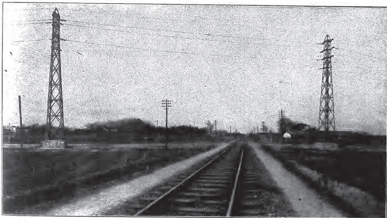
開北水電公司高壓架空綫及其鐵塔
