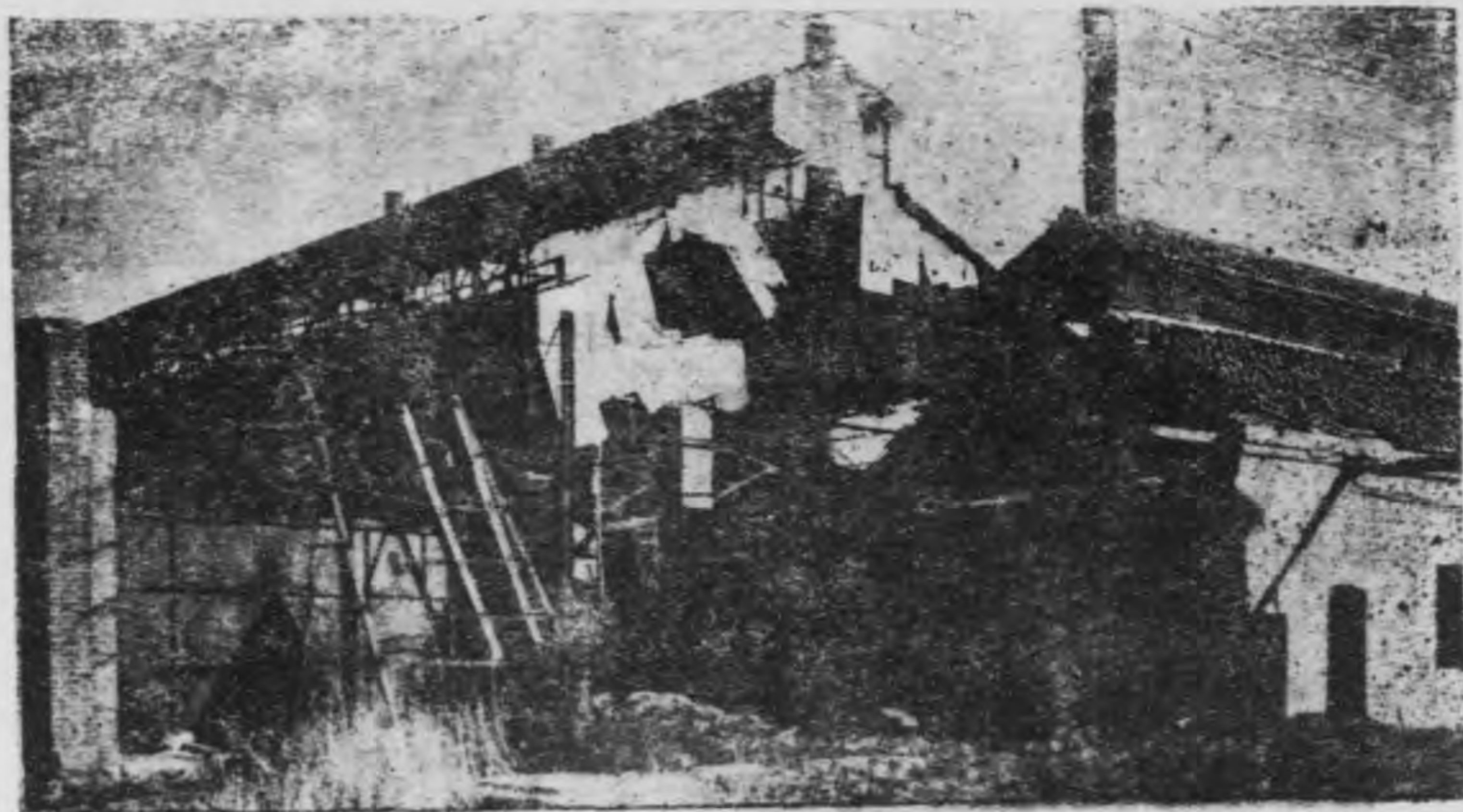
慘遭破壞之場房與設備
