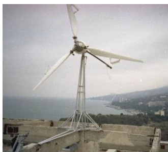
Рис. 4.2. Вітрогенератор на даху будинку
