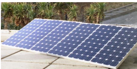
Рис. 4.3. Панель сонячних батарей загальною потужністю 0,5 кВт
