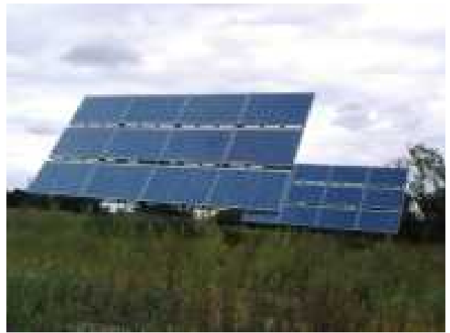
Fotovoltaikanlage in Berlin-Adlershof
