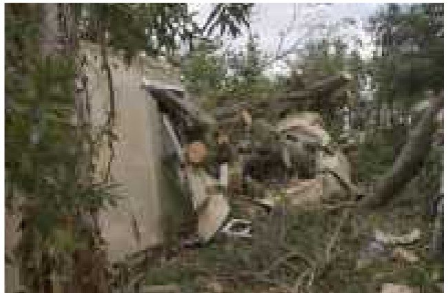
27. August: Schäden in Davie, Florida
