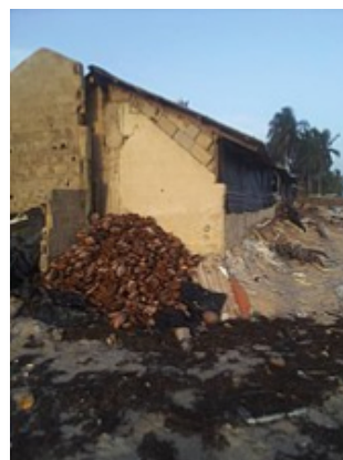
Dégâts causés par l'avancée de la mer
