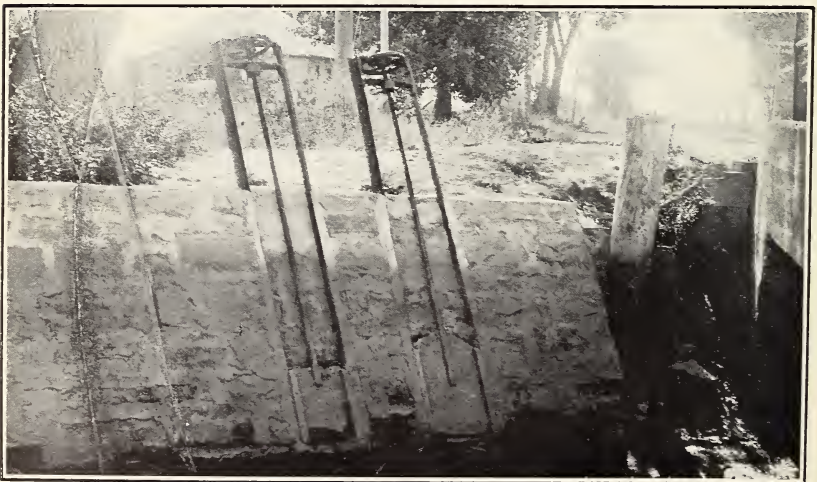
FIG. 3.—DELIVERY GATES ON NORTH Poudre CANAL, COLORADO.
