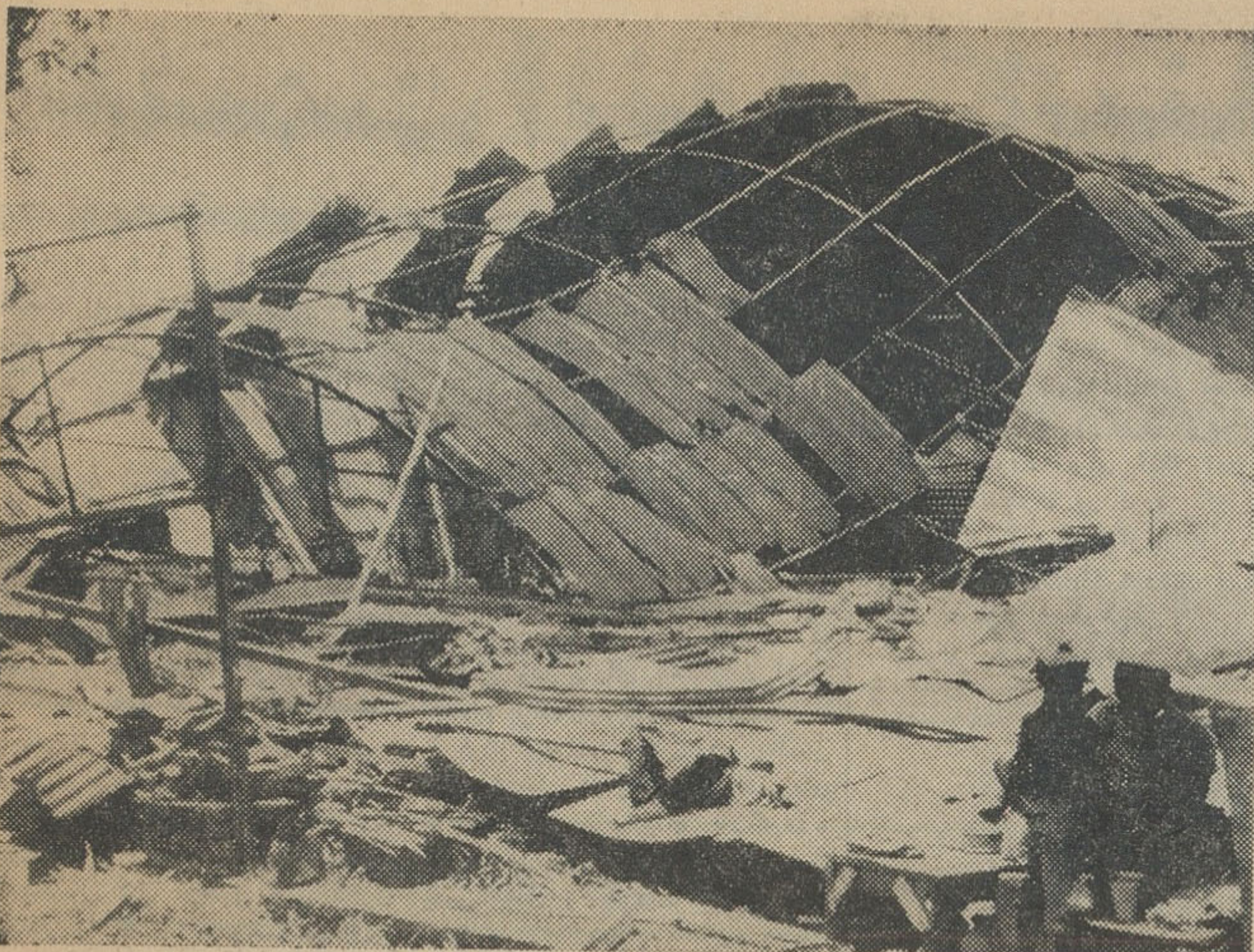
طوفان سهمگینی که اخیراً در پاکستان شرقی روی داد هزاران نفر را کشت و زانیای مالی هنگفتی ببار آورد. این عکس یکی از ساختمانهای چیتاگونگ را نشان میدهد که بر اثر طوفان خرد شده است.
