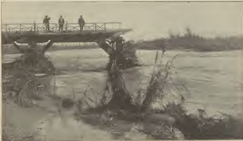
Restos del puente que cruzaba el Llobregat en la carretera de Barcelona á San Baudilio y que fué arrastrado por la corriente
