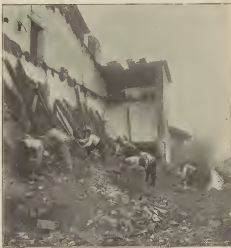
Otra casa conocida por el mismo nombre que ha quedado en parte derruida
