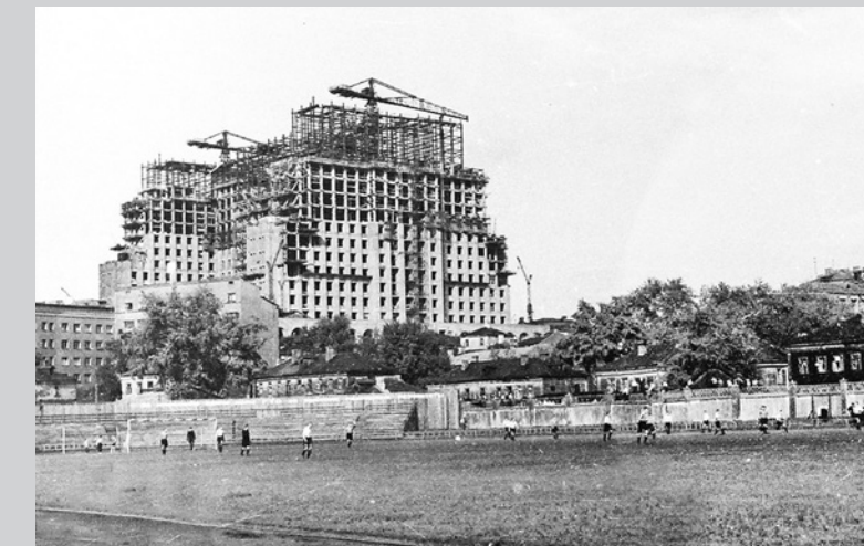
Вид на строящееся Высотное здание на площади Восстания со стадиона «Метростроя». Фото начала 1950-х годов.
