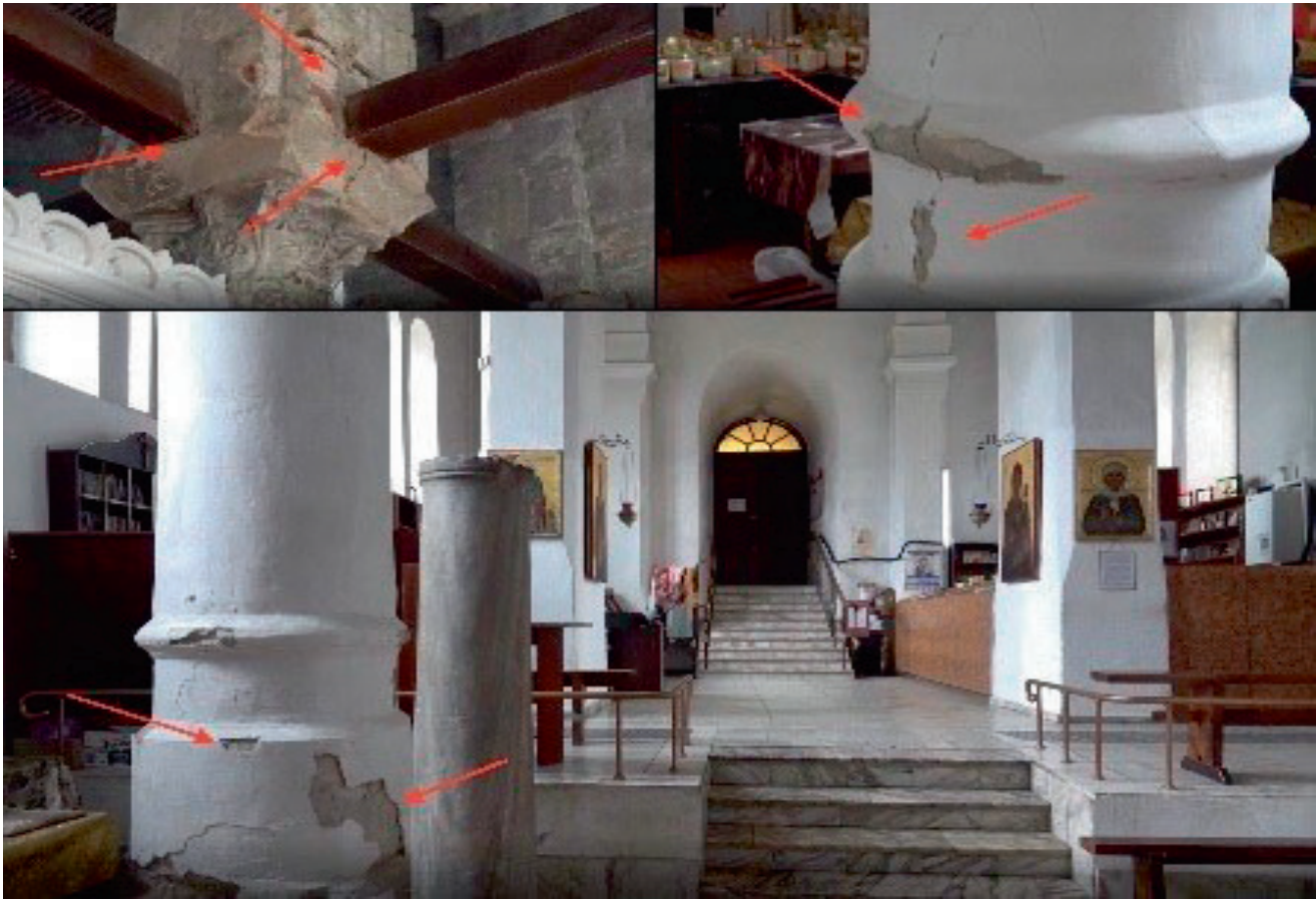
Відеофрагмент — тріщини колон Церкви Івана Предтечі, які зі слів місцевих жителів, з'явилися нещодавно, після будівництва готелю поруч із пам'яткою. Джерело — відеофайл з російської соціальної мережі «Вконтакте»
