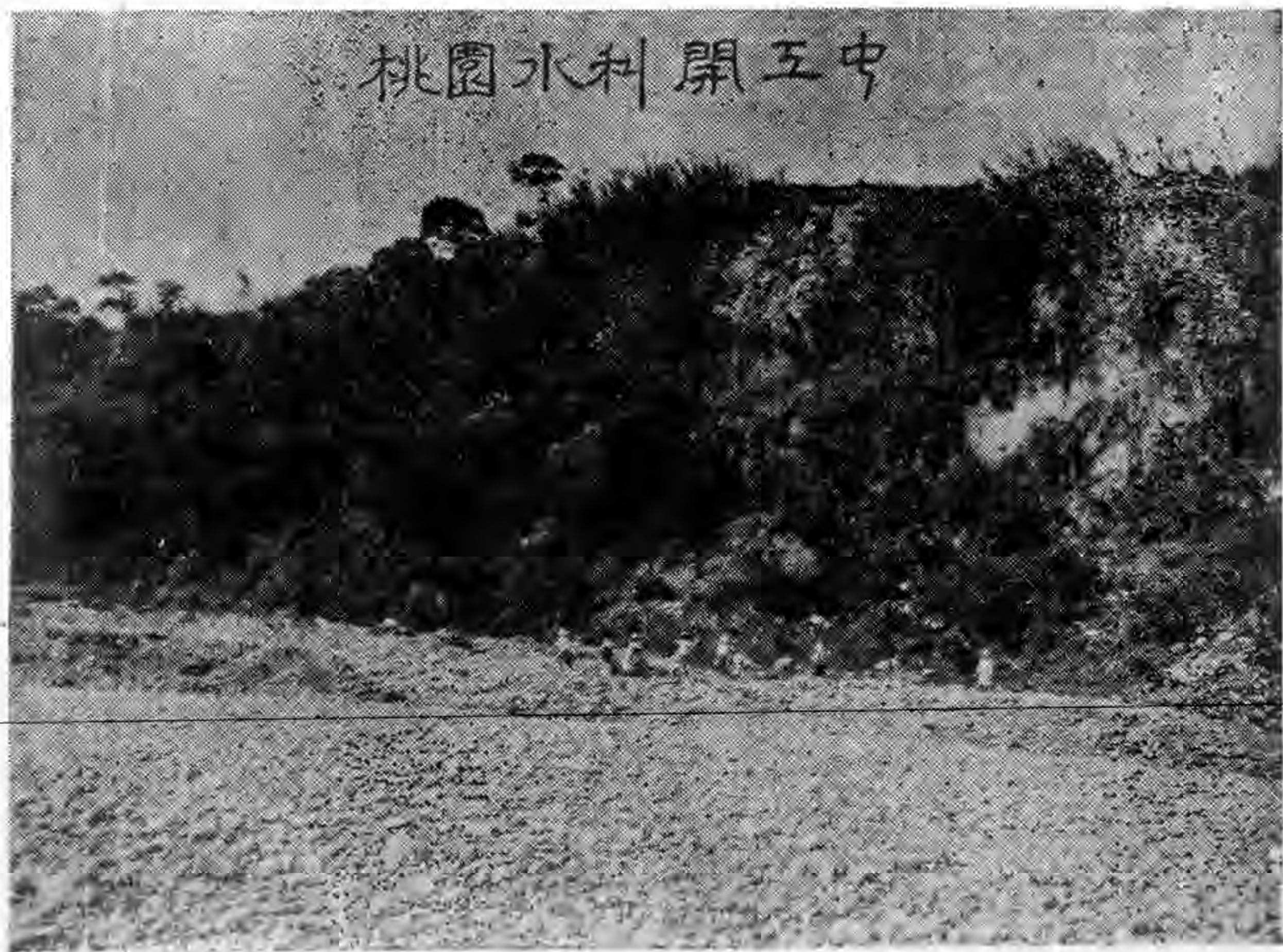
(三) 新竹縣桃園鎮水利工振工程開工中 請注意：那在巉巖頑石中工作的受振工人！
