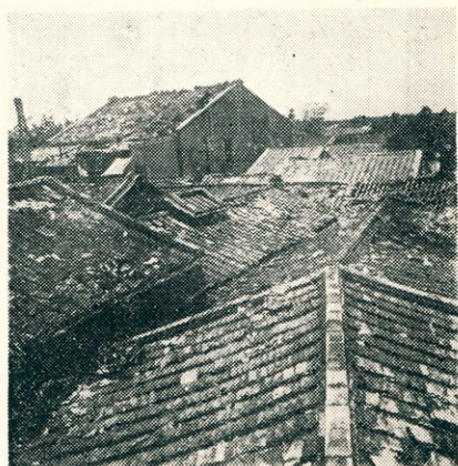
↑ 中央路磚砌樓房屋頂損壞
