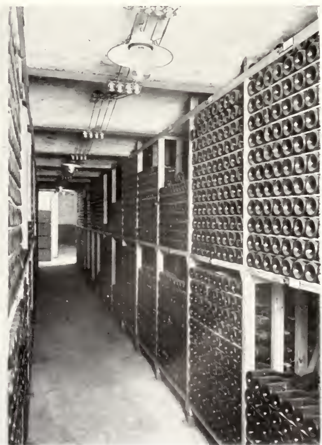
KÜHLRAUM FÜR WEINE UND WEINKELLER.
