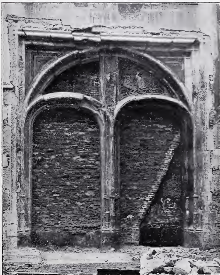
Gothische poort in den Zuider-transeptgevel van de N. Z. Kapel in de dikte van den muur gevonden.
