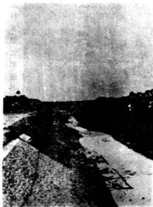
兩岸坡側壩卸甚劇需修理急
