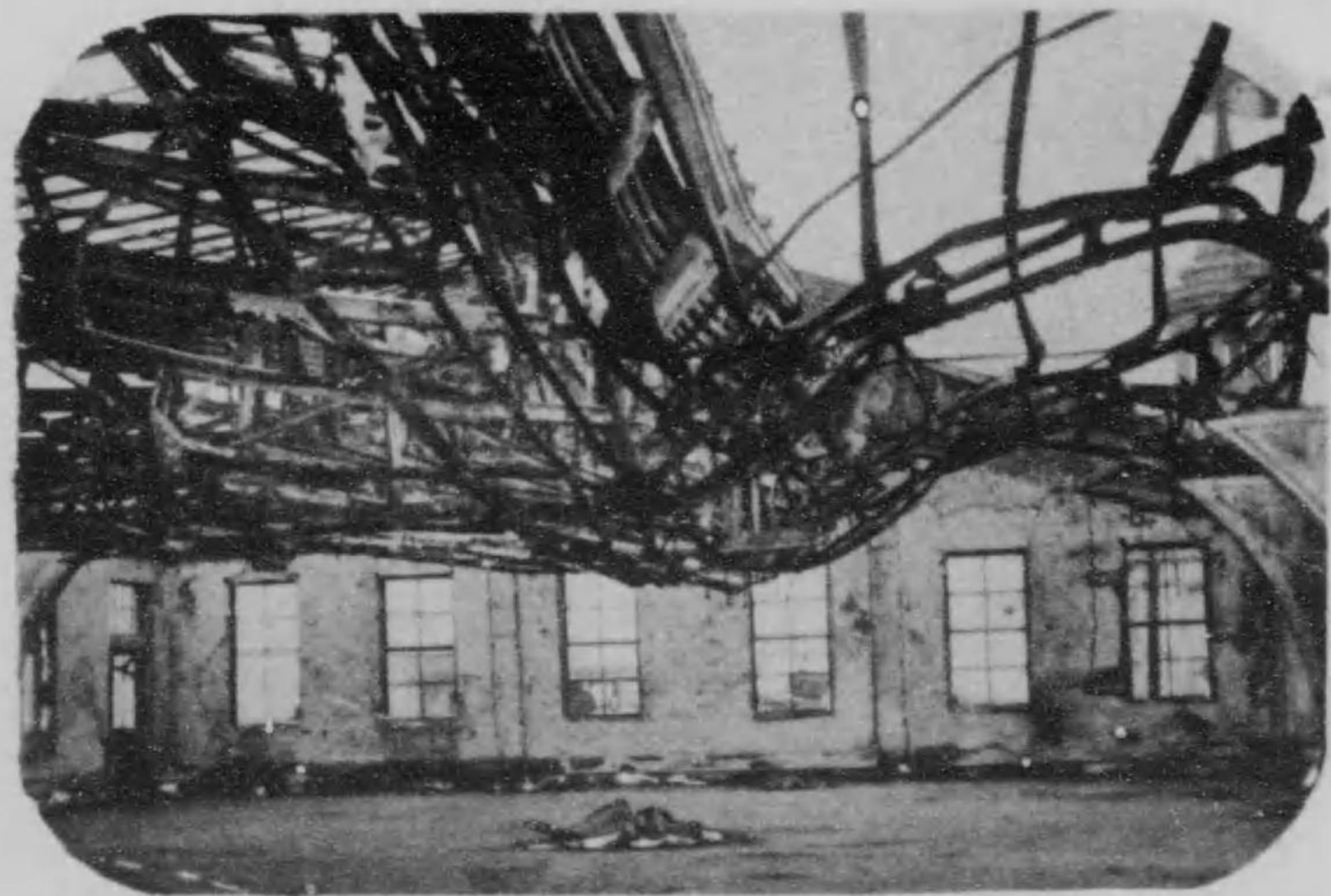
三越新館六階の焼跡
