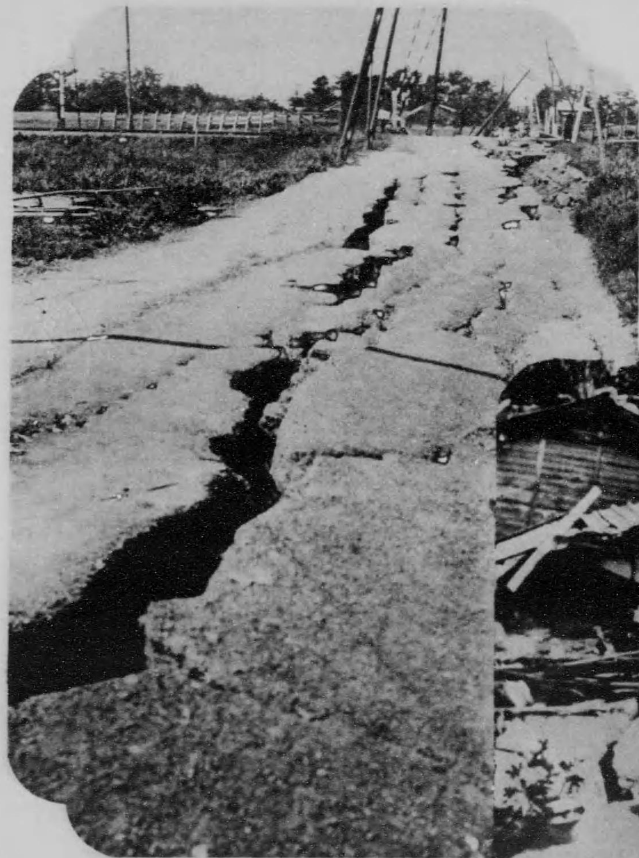
安房郡北條町路而龜裂の光景
