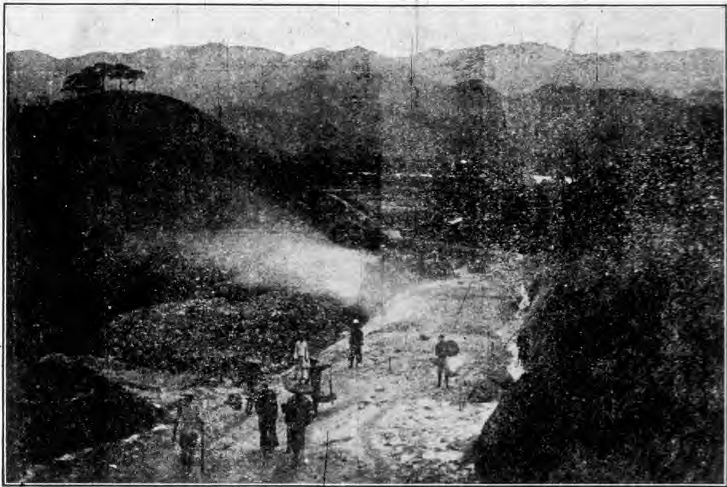
福建漳龍區公路分局開築漳龍幹路馬山段工程施狀況 (一)
