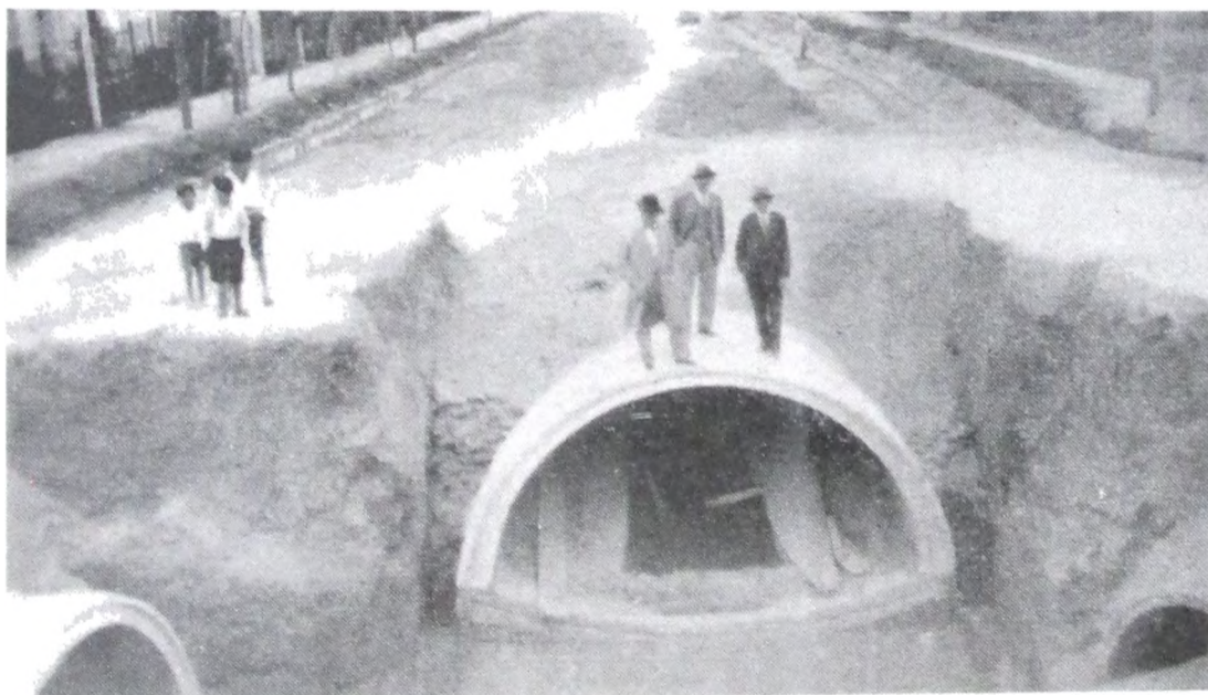
El colector máximo de los desagües pluviales (4,20 m. de diámetro) en la Avenida Talleres a la altura de la calle Lavalle.
