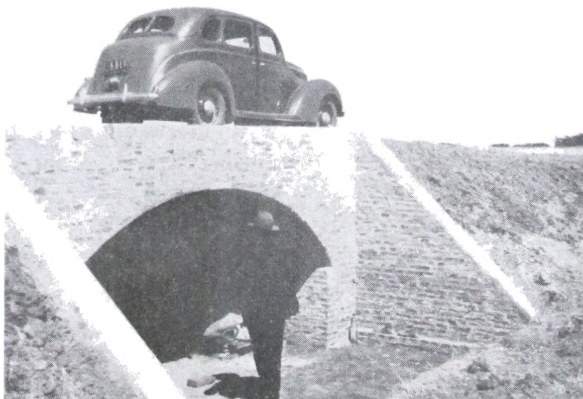
Fot. N° 30.— Canal Laguna Salada al Río Salado. Alcantarilla construída con bóveda de chapa ondulada en el Km. 9,0.
