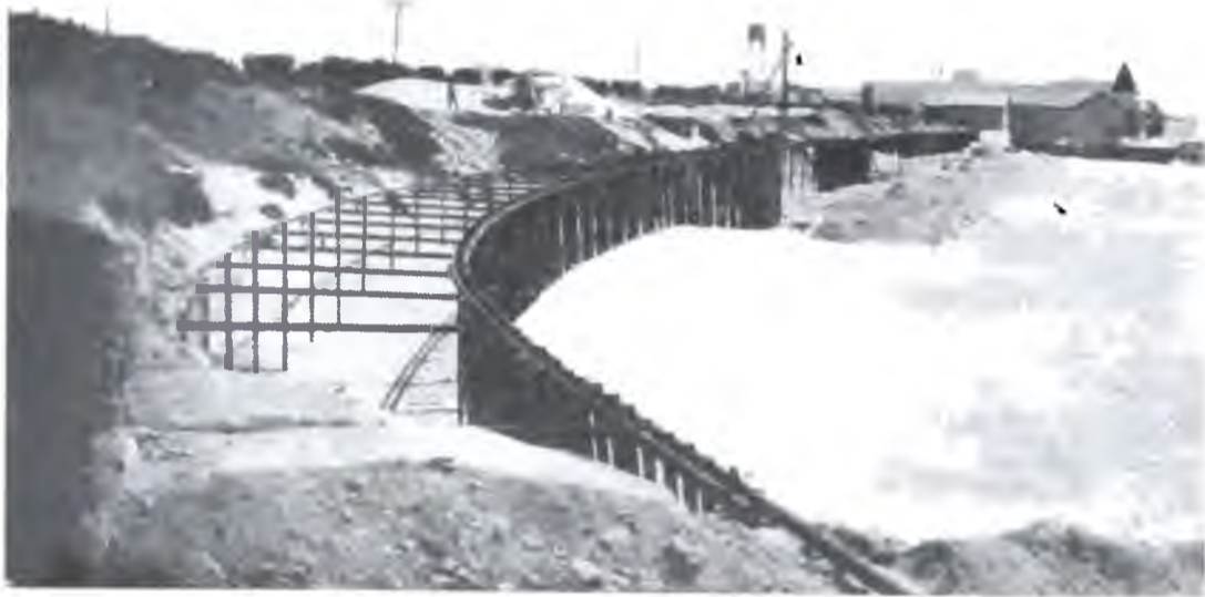
Nº 35. — Miramar — Año 1938. — Construcción de un muro para defensa de costa, al Sud de la rambla.
