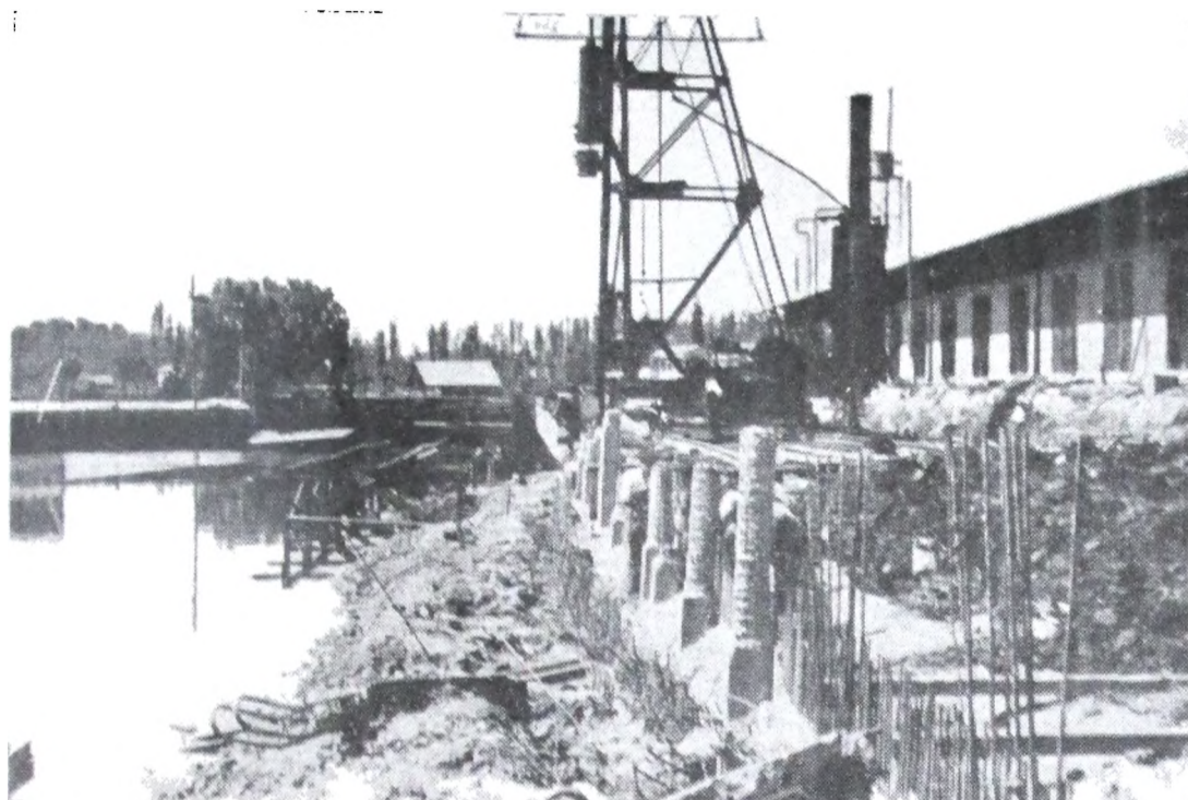
Vista durante la construcción del muro vertical, muro éste de la dársena 2.
