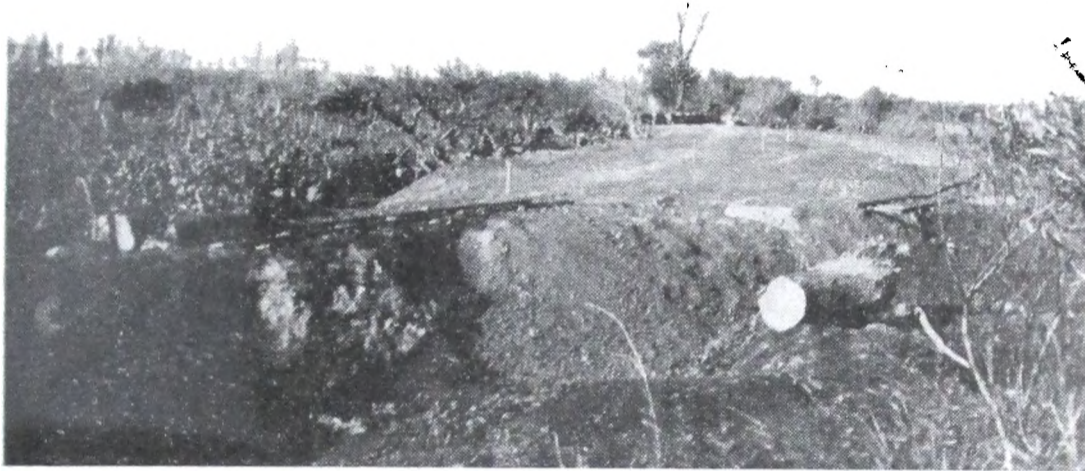
31/V/1938. — Progresiva 950 hacia 1100. Estado actual del terraplén
