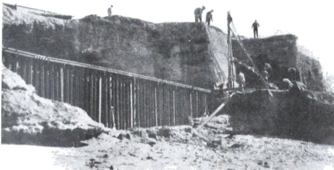
Nº 3. — Espigón «Solarium Nº 3» — Año 1938. — Hincas de rieles para construir una pared defensa pie de la barranca, al costado Sud del arranque.
