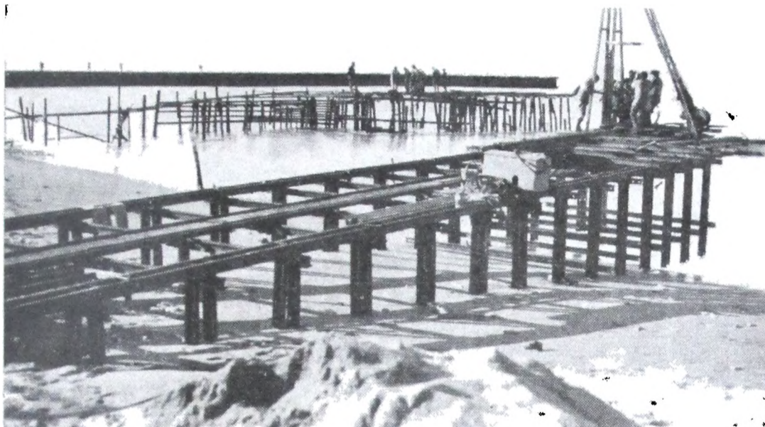
Nº 15. — Espigón «La Perla N° 2» — Año 1938. — Construcción del andamiaje inicial. En segundo término se ve el espigón Ciacaglia y Pierini, en demolición.
