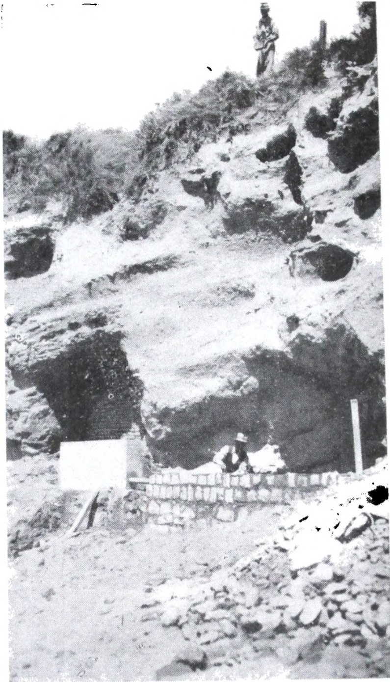
Nº 9. — Espigón «Unzué»—Año 1938. — Cañería y cámara construídas para desviar los desagües del Asilo, al Norte del espigón.
