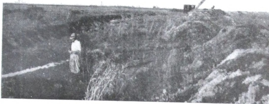
Fot. N° 27. — Canal de Cazón - Desvío Toledo al A. Saladillo. Trecho de canal en ejecución.
