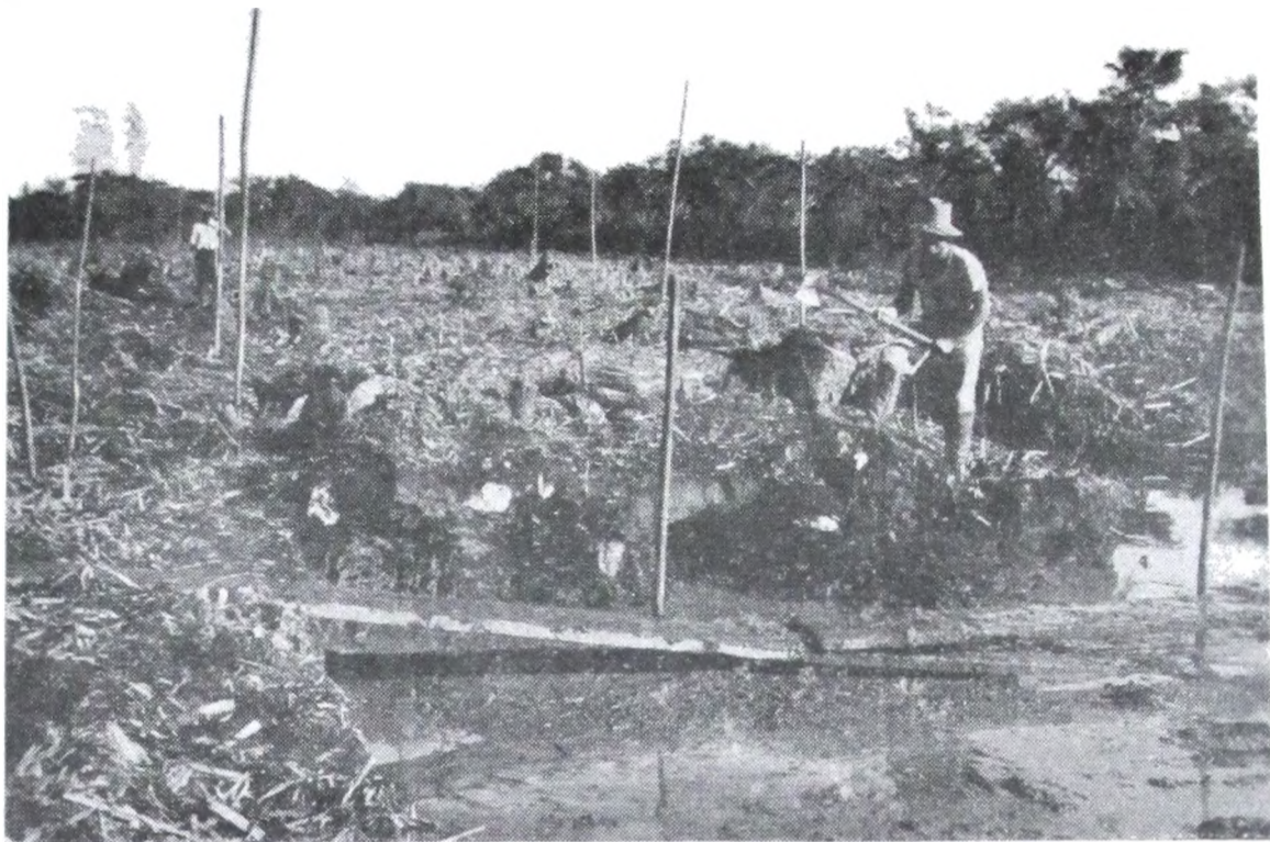
Desvío zanja Torres a Punta Morán (2ª sección de Islas).— Cuadrilla terraplenera 254 D realizando trabajos preparatorios para el dragado. Nótese el trabajo ímprobo para la cancha del dragado; terreno completamente inundable; corte de árboles cuyos troncos y raíces deberán ser sacados por la cuadrilla, etc.
