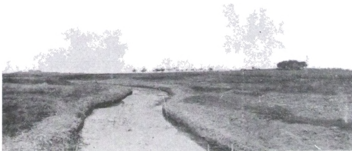
Rectificación y limpieza del Río Salado. El cauce del río visto desde el Puente Sosa, mirando aguas arriba, después de la limpieza; falta el corte de taludes.— Enero 25 de 1938.
