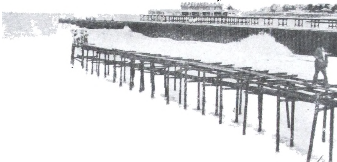
Nº 21. — Pileta Municipal — Año 1938. — Reparaciones efectuadas en el esqueleto de rieles que sostiene la cañería de toma.
