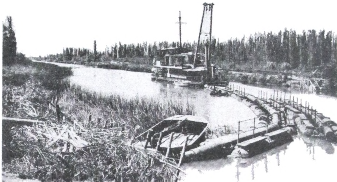
Canal Gobernador de la Serna (2ª sección de Islas). — Draga 220 C del Ministerio de Obras Públicas de la Nación, durante los trabajos de profundización del citado canal, desde la desembocadura del Arroyo Desengaño hasta el Arroyo Pay-Carabí.
