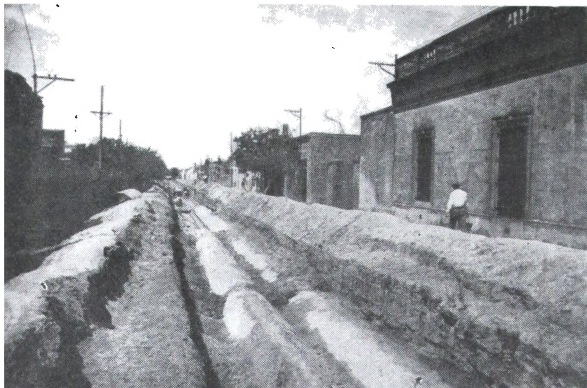
Conducto doble calle 23.
