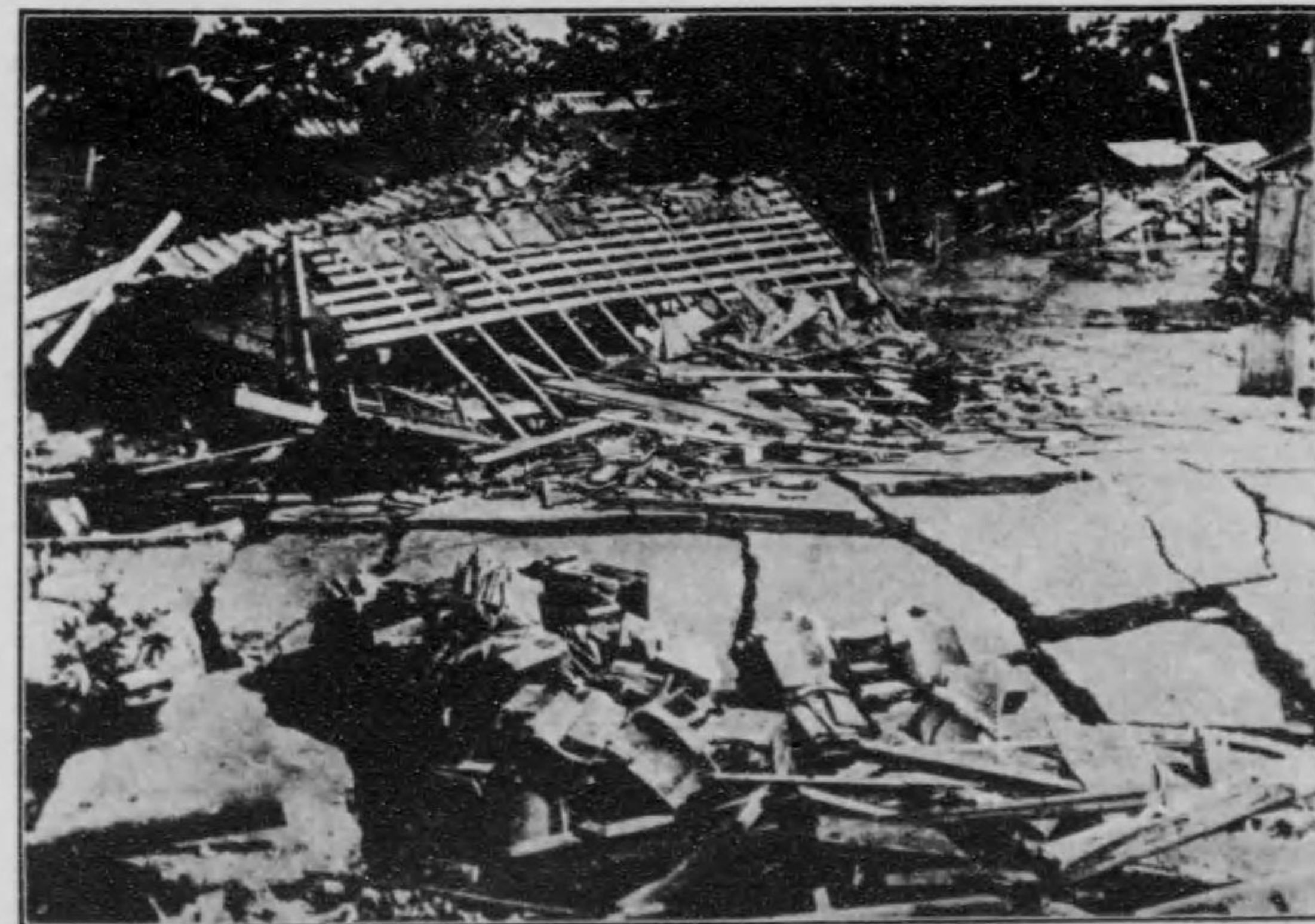
道 路 龜 裂 の 状 況 (其 二) (北 條 地 内)
