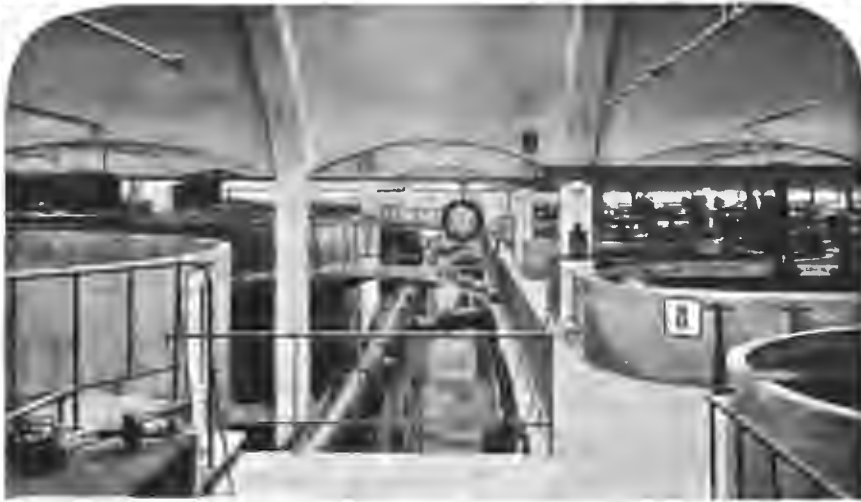
Фильтры съ мѣшалками, черезъ которыхъ озонированная вода направляется въ водопроводныя трубы.
