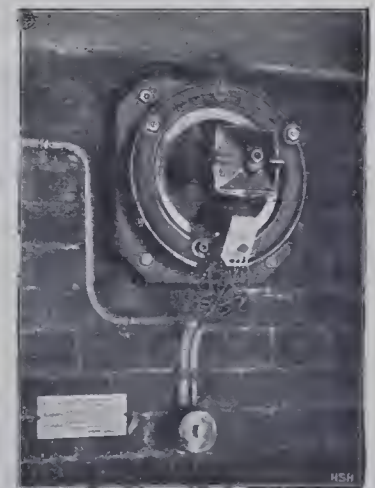
Abb. 14. Ventilator mit Irisblende vor einem gemauerten Raumabluftrohr.
