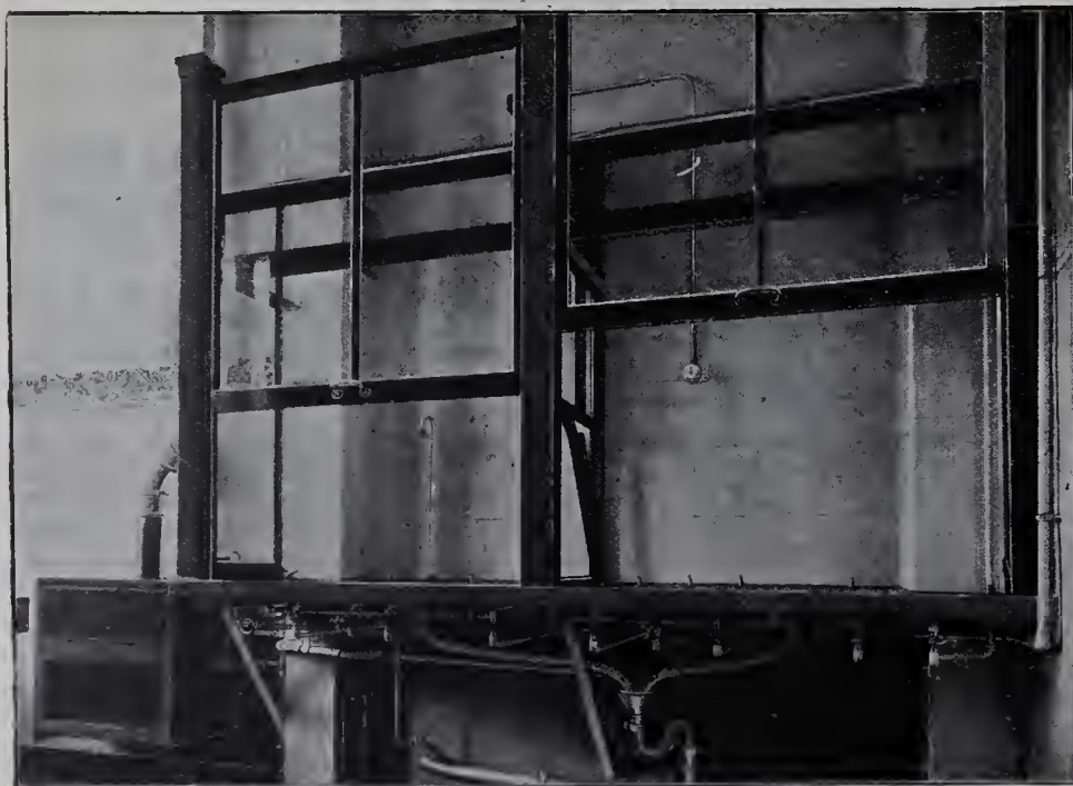
Abb. 11. Zweiteilige Wandkapelle im Dampfdestillationsraum der Abteilung für Ölprüfung.
