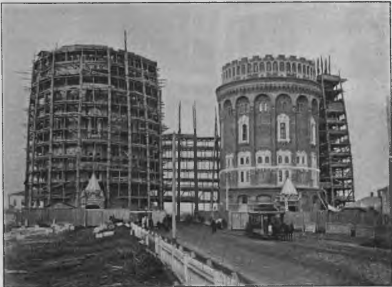
Видъ восточной башни частію освобожденной отъ лѣсовъ. Подъемная машина еще обслуживаетъ работы по постройкѣ западной башни. Видъ съ юга.
