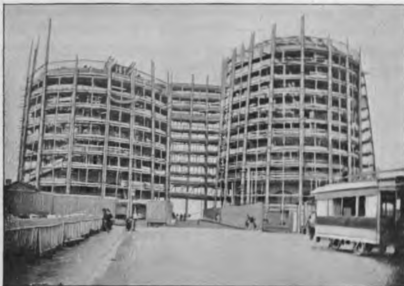
Видъ законченной кладкою восточной башни въ связи съ положеніемъ работъ на западной башнѣ.
