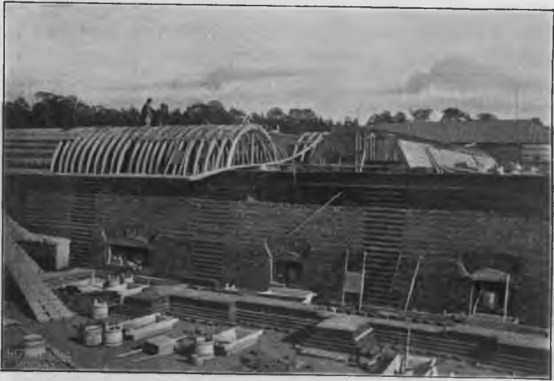
На переднемъ планѣ кладка подвальной части вестибюля, на заднемъ планѣ опалубка кружалъ для кладки сводовъ.
