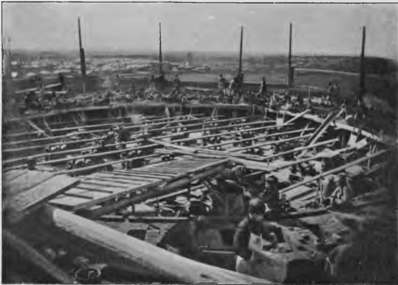
Устройство подмостей на клеткахъ изъ дровъ для сборки днища резервуара западной башни.
