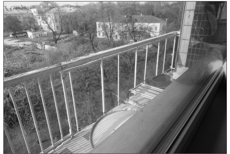
Фото балкона квартири академіка П.Т.Тронька з отворами в огороженні
