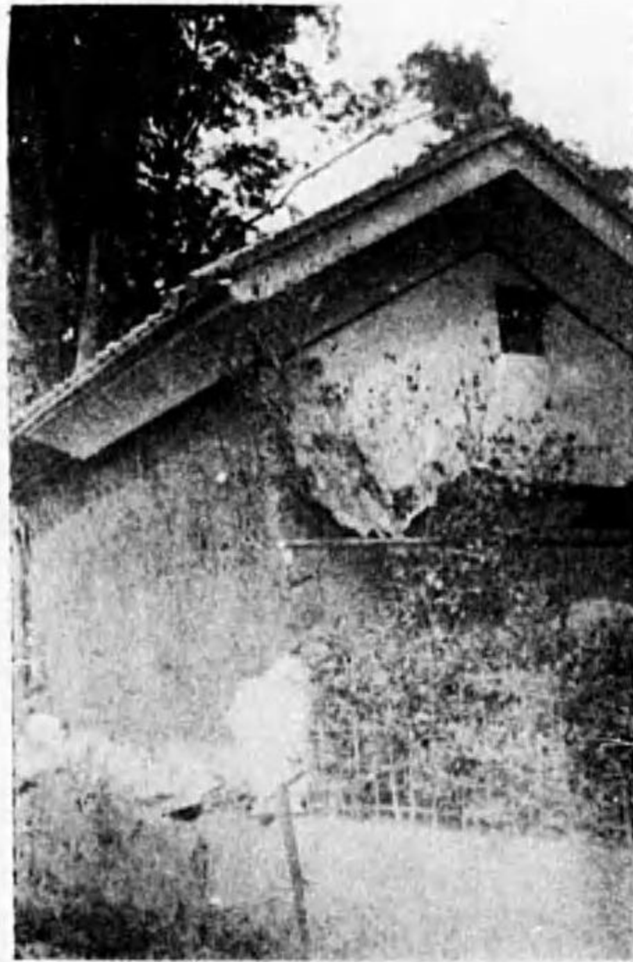
第六十圖 大寄村大字戸森土藏の壁崩落
