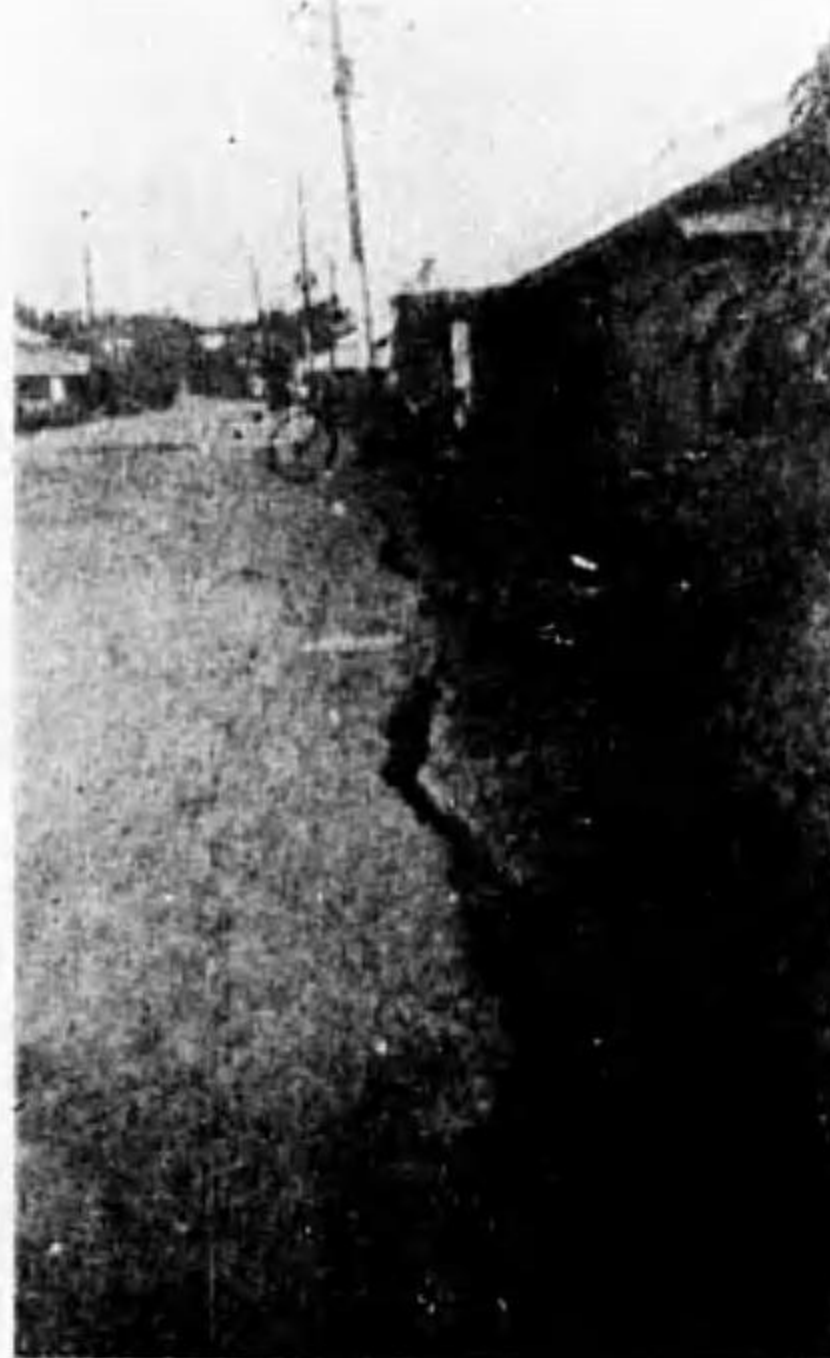
第三十圖 熊谷町道路の龜裂、荒川大橋より熊谷町に向つて撮す
