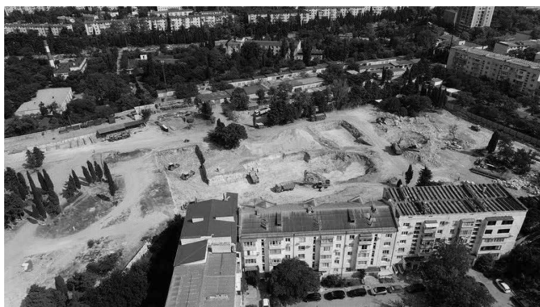
На території Південного передмістя древнього городища «Херсонес Таврійський» почались будівельні роботи зі спорудження історико-археологічного парку. Серпень 2021 року.
