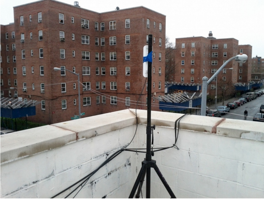
Figura EcOTI 4: Primer nodo WiFi de RHI (Ubiquiti Nanostation) instalado en el techo del edificio de las oficinas de RHI
