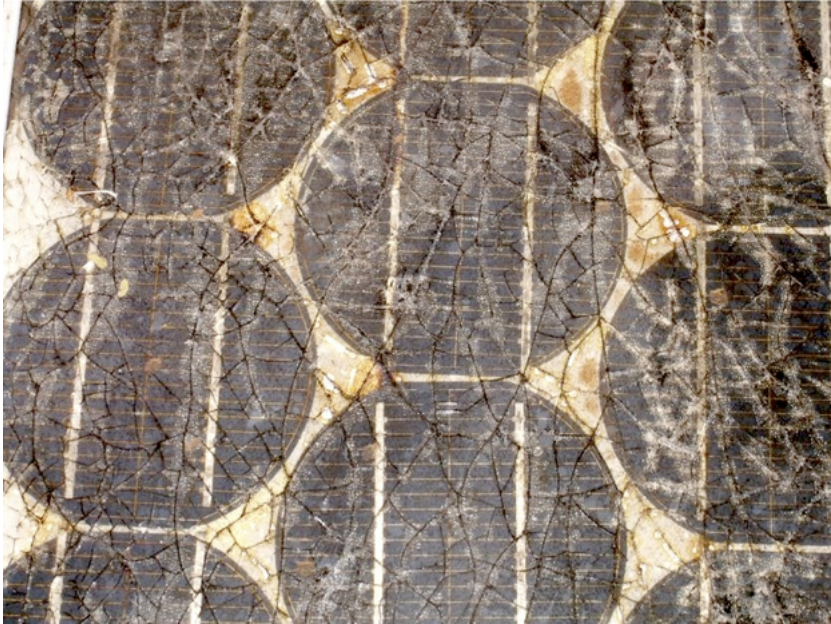
Figura EA 6: Efectos del agua y la corrosión en un panel solar
