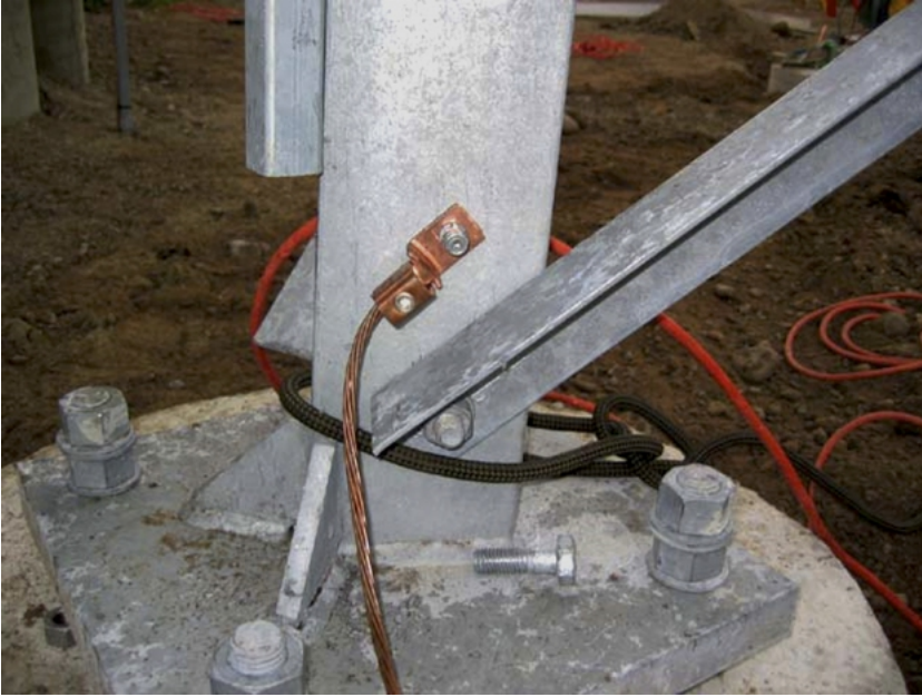
Figura SCH3: Torre con un cable de cobre grueso conectado a tierra
