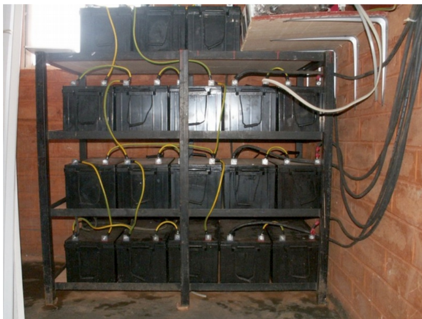
Figura EA 9: Un banco de baterías de 3.600 Ah. La corriente alcanza niveles de 45 A durante la carga
