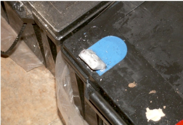
Figura EA 2: Batería de plomo-ácido de 200 Ah. El terminal negativo está roto por haberle aplicado peso durante el transporte
