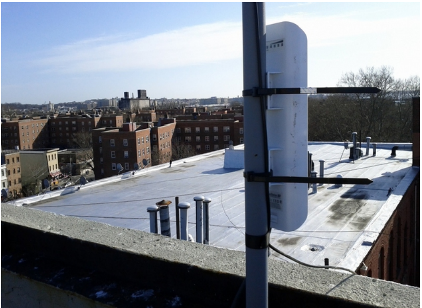
Figura EcOTI 6: El nodo instalado en el techo del edificio
