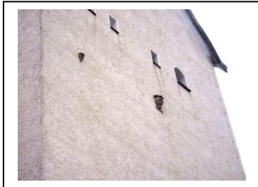
Lonsee-Kirchturm Zwei Kopfreiefs (Baumeisterköpfe) im oberen Bereich-081109
