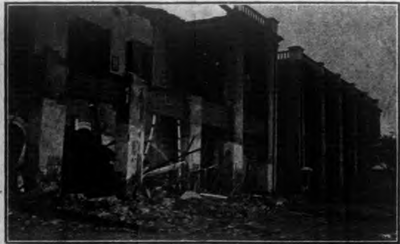
潮海關倒塌情形
